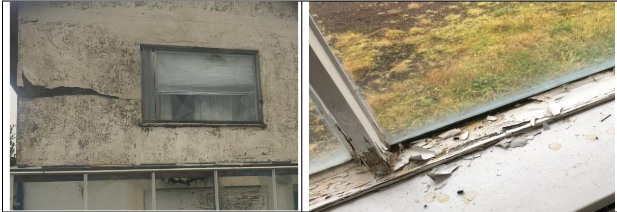
Myndir. Þarf að fara í sprunguviðgerðir og endurmálun utanhúss. Endurnýja þarf alla glugga hússins.
