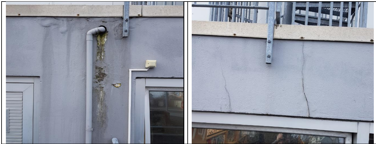
Myndir. Fara þarf í múr- og sprunguviðgerðir á útveggjum.
