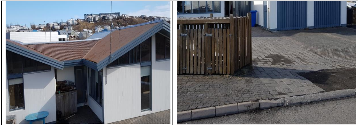
Mynd.. Endurnýja þarf þakjárn. Lagfæra þarf hellur og aðlaga lóð við bæjarland.
