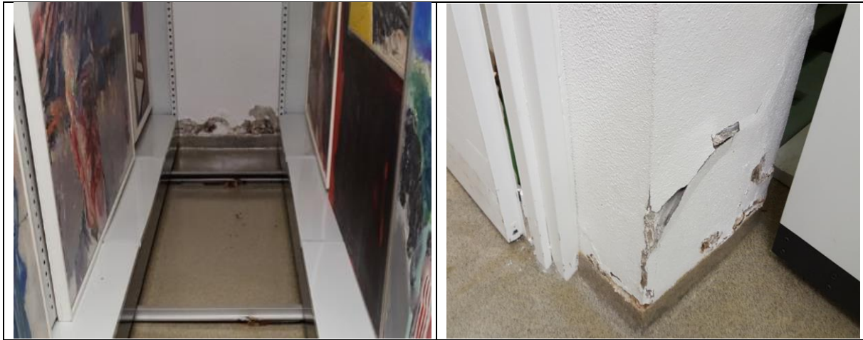
Mynd. Fjarlægja þarf listaverk og aðra muni úr kjallara vegna rakavandamála. Þarf að skoða lausnir varðandi rakavandamál.
