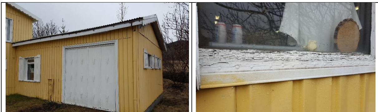
Mynd. Endurnýja þarf klæðningu og glugga hússins að hluta vegna fúa.
