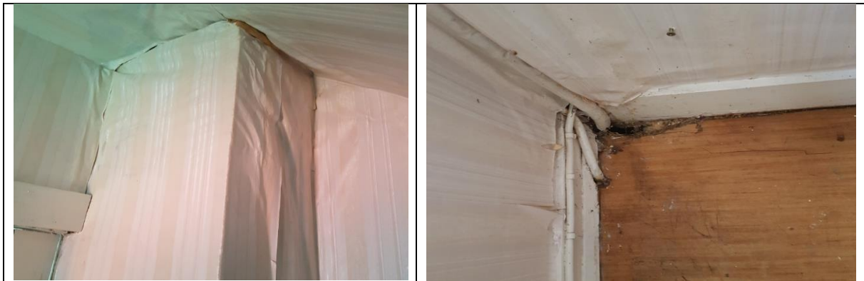
Mynd. Endurnýja þarf veggklæðningu vegna leka. Endurnýja þarf gólfefni.
