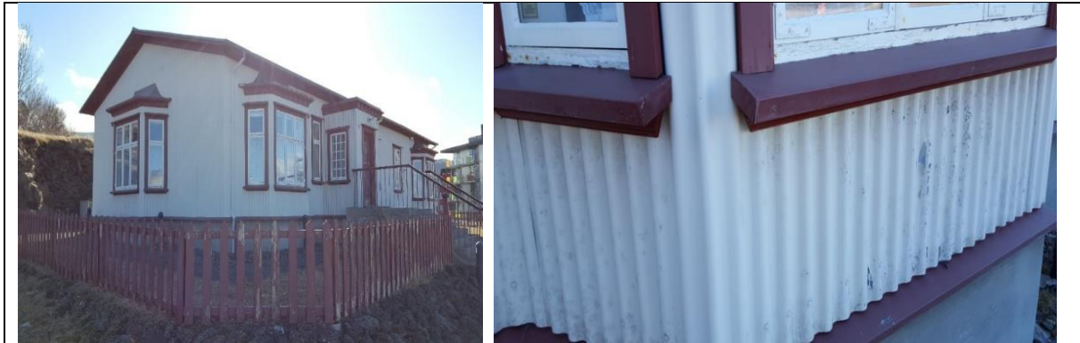
Mynd. Endurmála þarf bárujárnsklæðningu.
