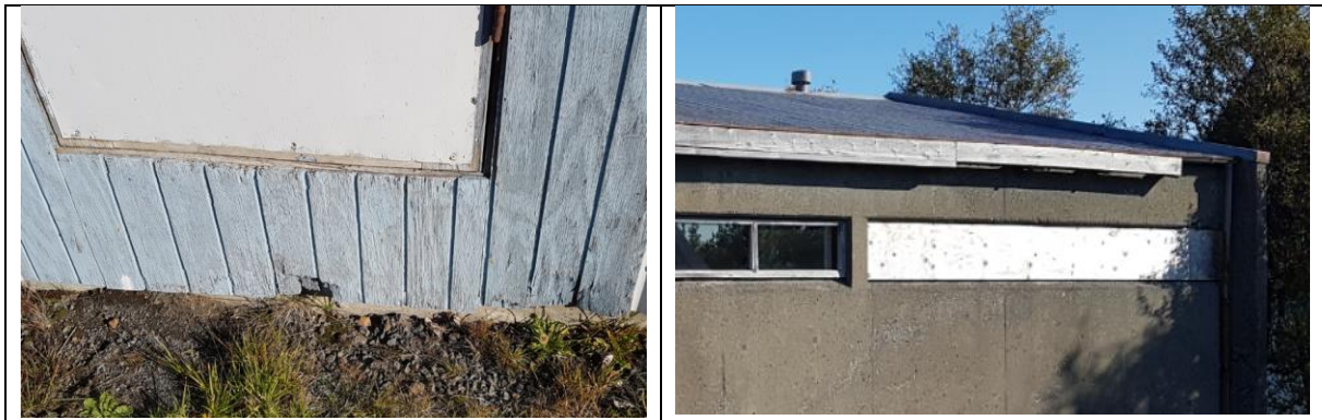
Mynd. Endurnýja þarf timburklæðningu utanhúss. Endurnýja þarf þakjárn, rennur, niðurföll og þakkant á geymslu.
