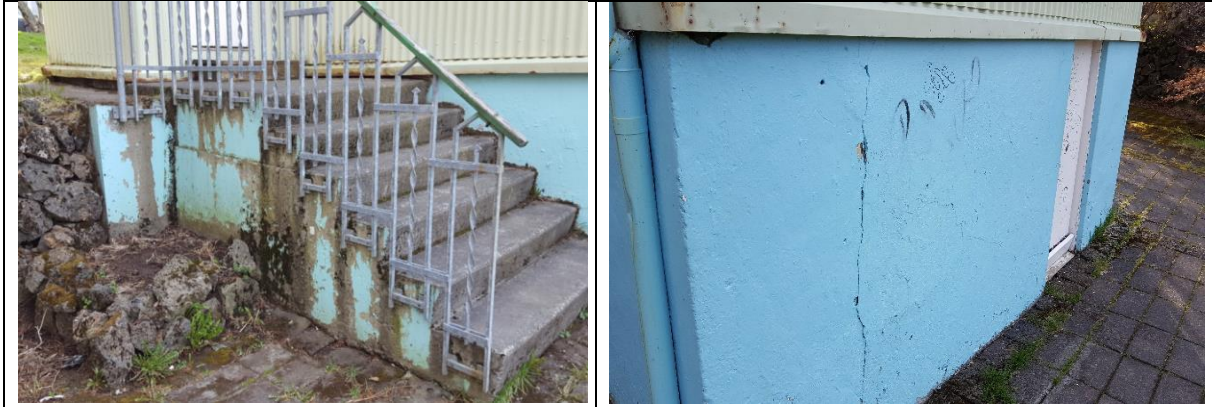
Mynd. Gera þarf við steypuskemmdir.
