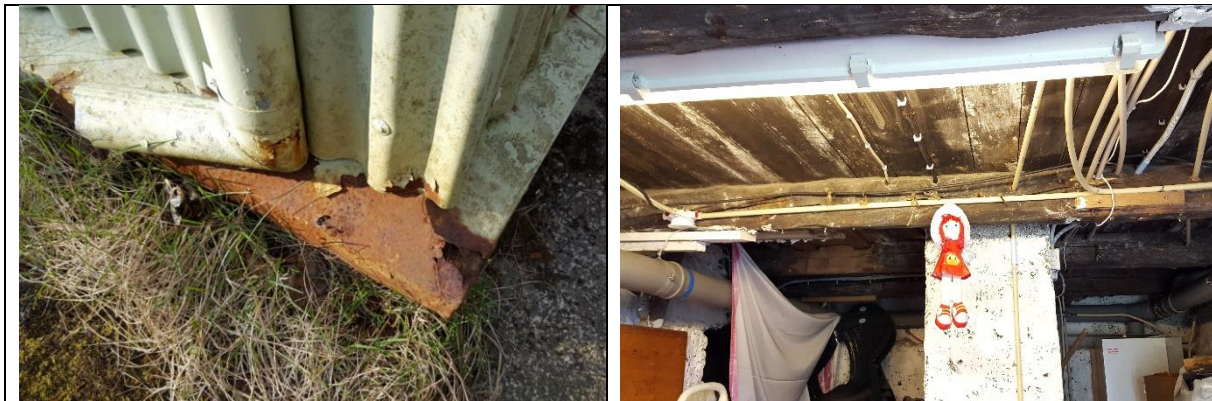
Mynd. Botnstykki orðið fútið og klæðning farin að ryðga. Í kjallara er rakavandamál og ummerki sýnileg á timburborðum og burðarbitum.
