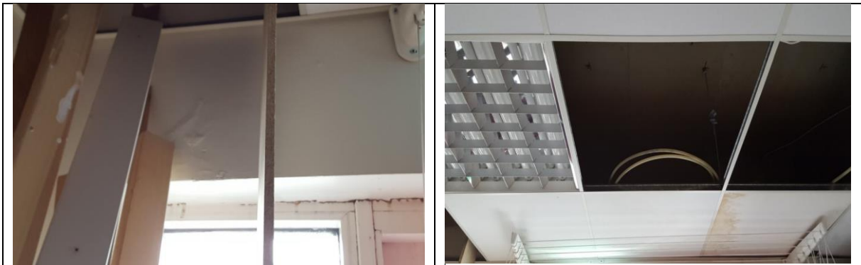
Mynd. Í þvottahúsi eru leka og rakavandamál, ummerki bólginn málning. Gera þarf endurbætur innanhúss þegar búið er að koma í veg fyrir leka og raka.
