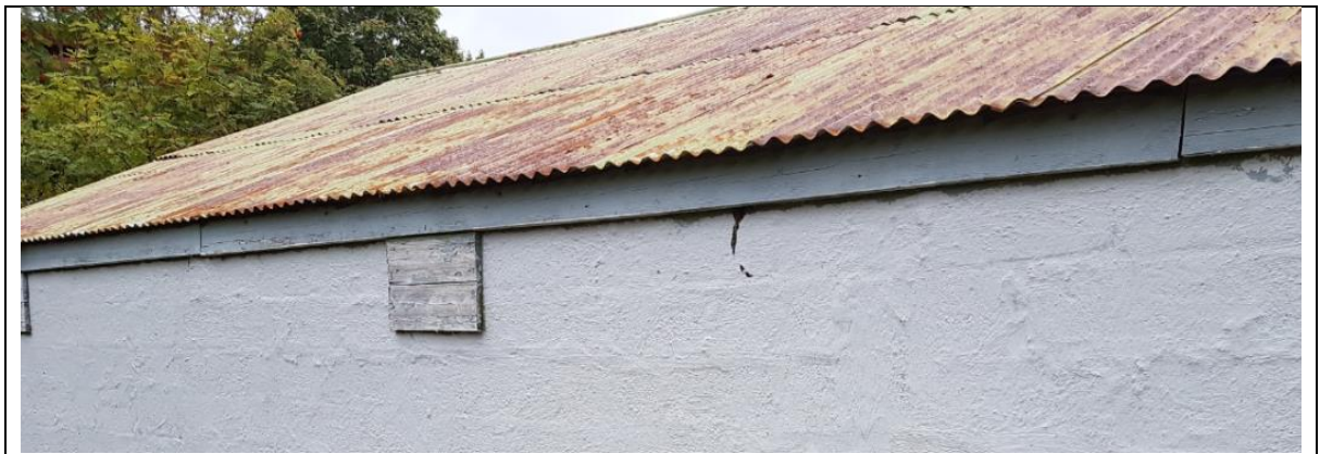
Myndir. Endurnýja þarf þakjárn, rennur og niðurföll.
