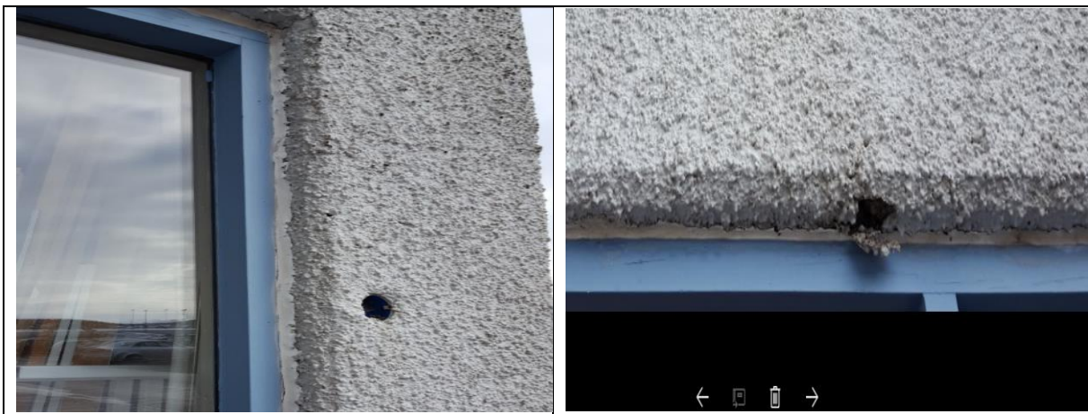
Mynd. Yfirfara þarf þéttingar með gluggum vegna leka og rakavandamála.
