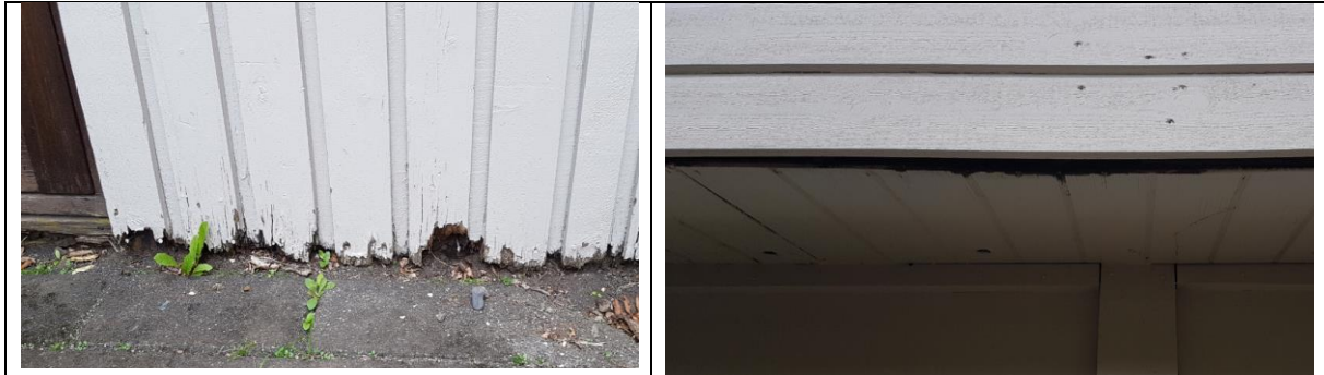
Mynd. Endurnýja þarf veggklæðingu og þakkant að hluta vegna fúa.
