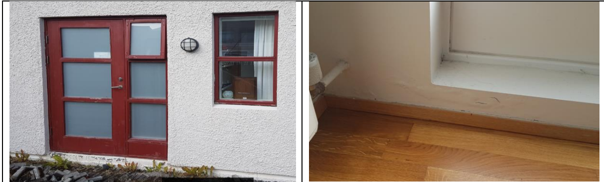
Mynd. Koma þarf í veg fyrir leka með hurð og lagfæra rakaskemmdir innanhúss.
