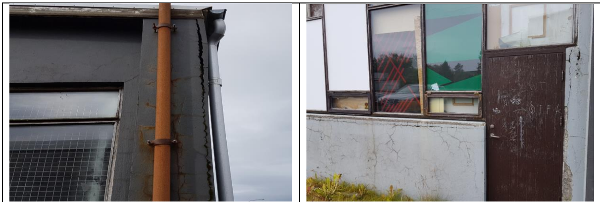
Mynd. Endurnýja þarf múrklæðningu að hluta og fara í sprunguviðgerðir.
