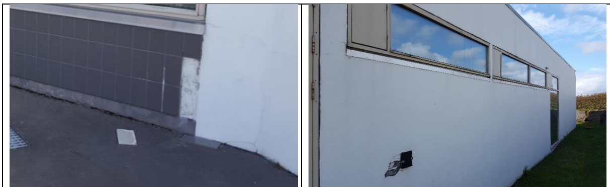
Mynd. Þarf að lagfæra veggflísar utanhúss. Lagfæra þarf sprungur í steiptum veggjum og aðrar múrskemmdir.
