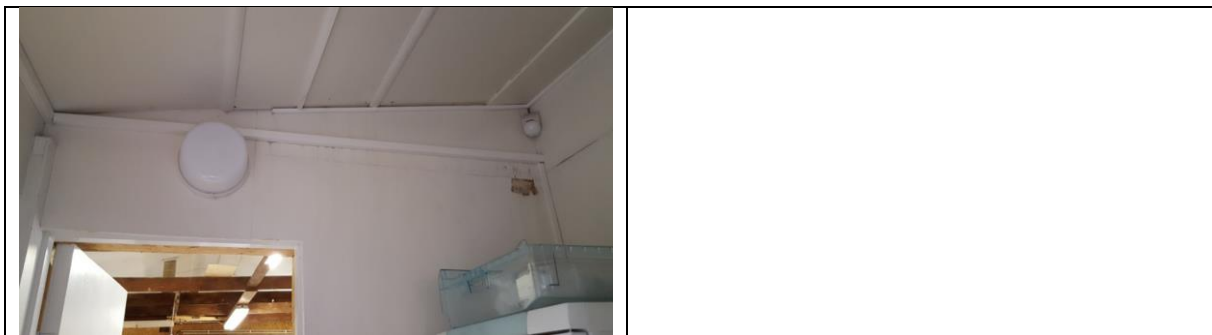
Mynd. Koma þarf í veg fyrir leka sem skilar sér inn við þvottahús.
