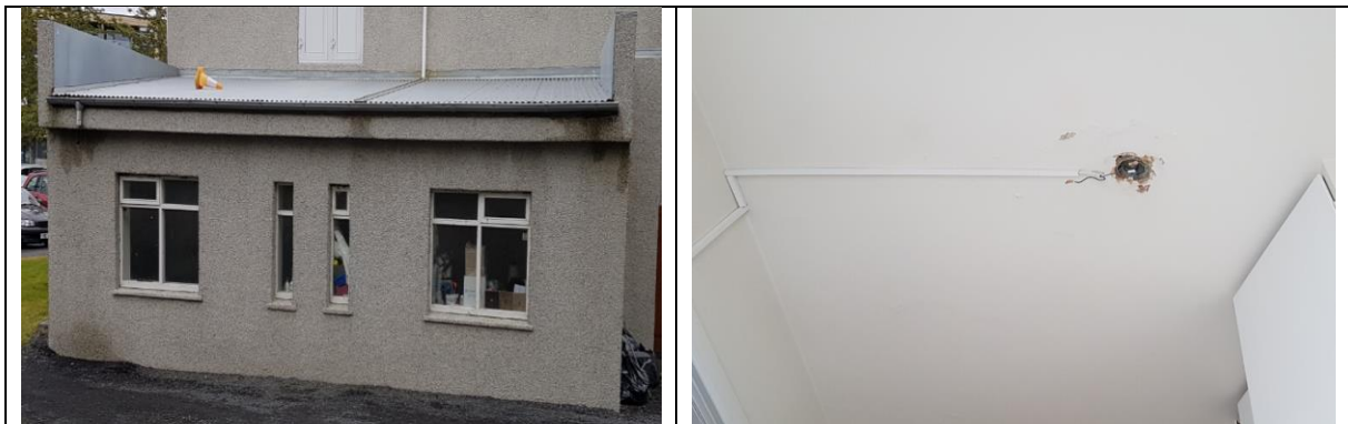
Myndir. Laga þarf leka á þaki á tveimur stöðum.
