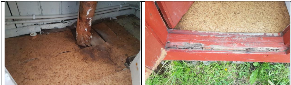
Mynd. Endurnýja gólf undir vaski vegna fúa. Endurnýja þarf útihurð vegna fúa.
