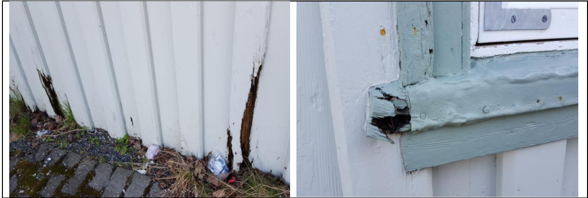
Myndir. Endurnýja þarf veggklæðningu og glugga vegna fúa.
