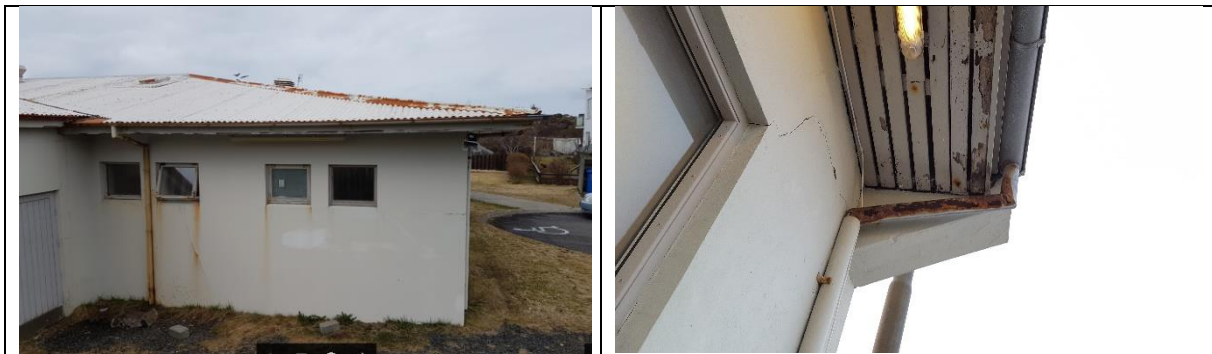
Mynd. Skipta þarf um þakjárn, rennur, niðurföll og þakskegg að hluta.
