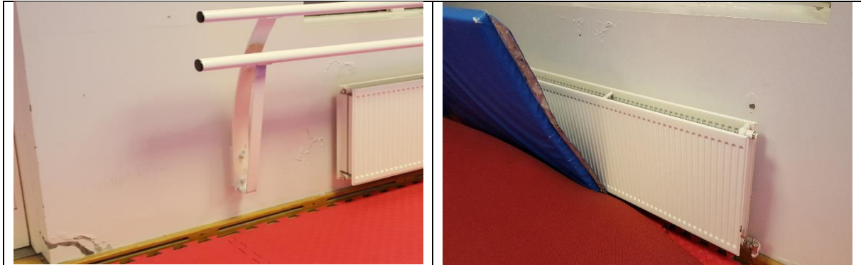
Mynd. Víða þarf að endurmála og laga vegna rakaskemmda.
