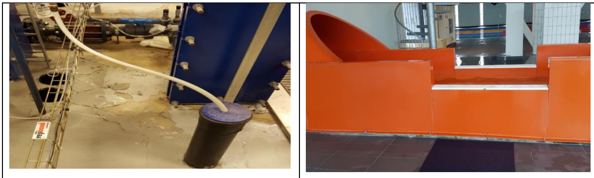
Mynd. Lakka þarf gólf í tæknirými. Rennibraut byrjuð að springa við útgang, þarfnast lagfæringar og aukna styrkingu.
