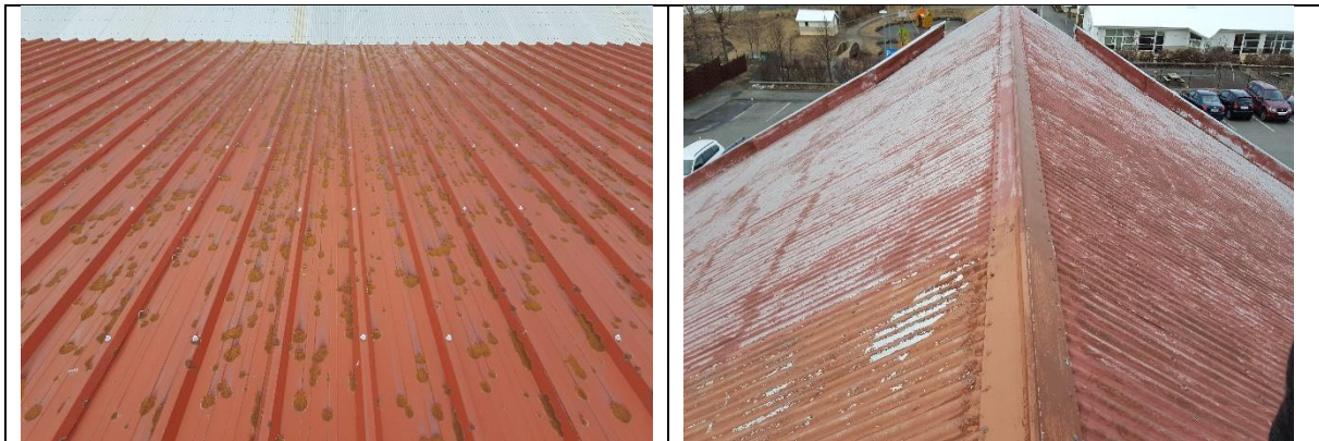
Mynd. Trapisupakjárn er orðið töluvert ryðgað og þarf að endurnýja. Bárujárnsþak þarf að endurmála.
