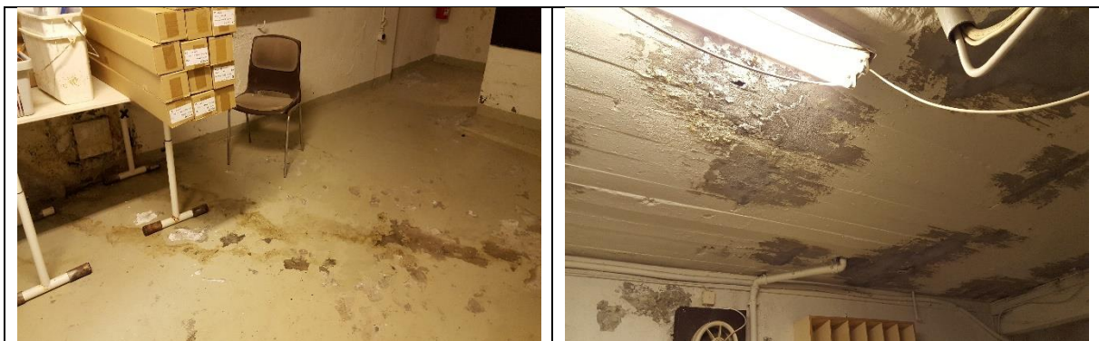
Mynd. Lakka þarf gólf í tæknirými og endurmála vegg og loft.
