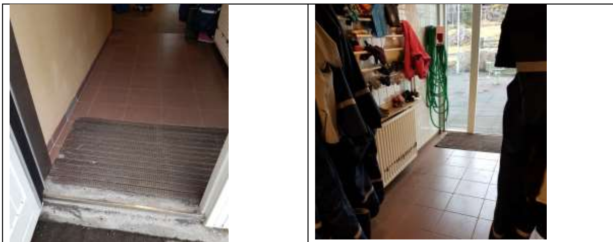
Mynd. Skipta þarf út gólfefnum og laga þurrkaðstöðu.
