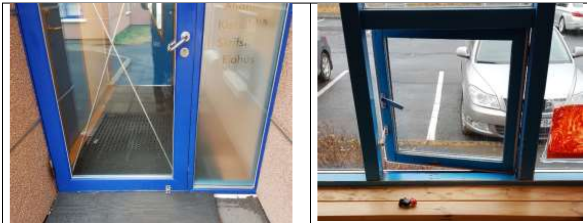
Mynd. Skipta þarf um útihurðar. Skipta þarf um opnanleg fög á nokkrum stöðum þar sem þau leka.
