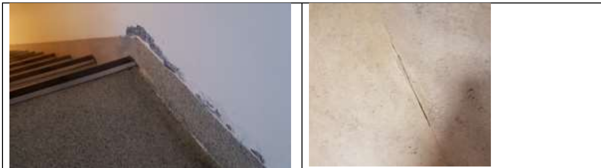
Mynd. Finna ástæðu fyrir leka og fyrirbyggja leka í gangi. Yfirfara og laga suður á gólfdukk.
