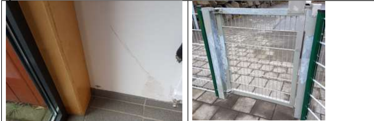
Mynd. Laga þarf smáleka á veggnum. Mála girðingu/hlið
