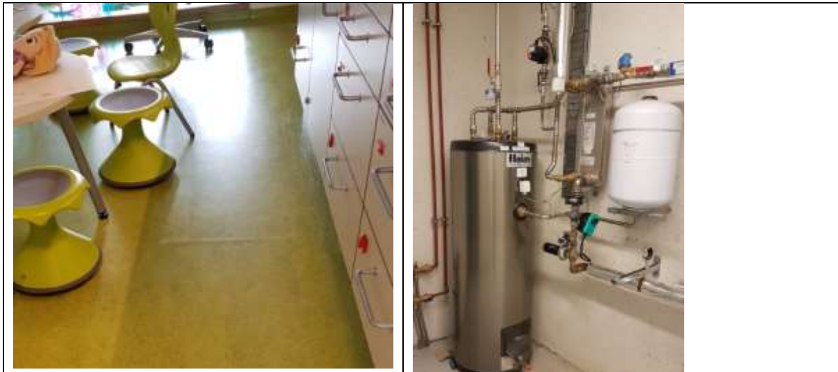
Mynd. Dúkur byrjaður að bóligna upp og flísar að losna. Breyta þarf hitaveitugrind til að minnka heitavatnsnotkun.
