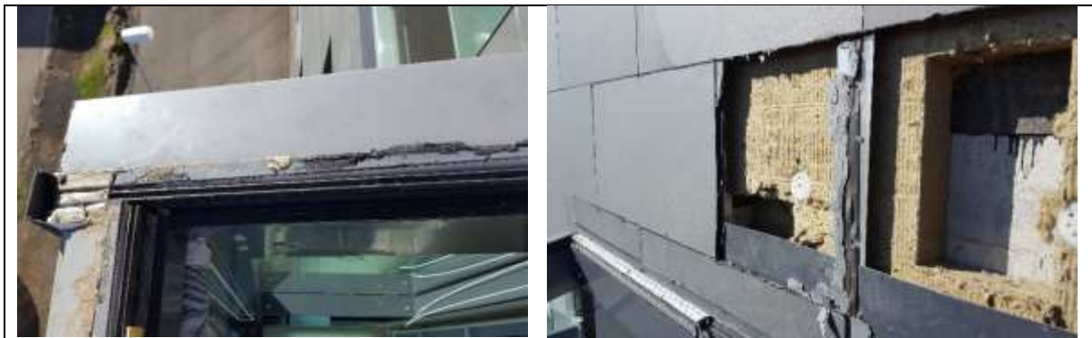
Mynd. Frágangur álkerfis við steypa veggi og glugga er ekki í lagi og og veldur lekum innandyrá
