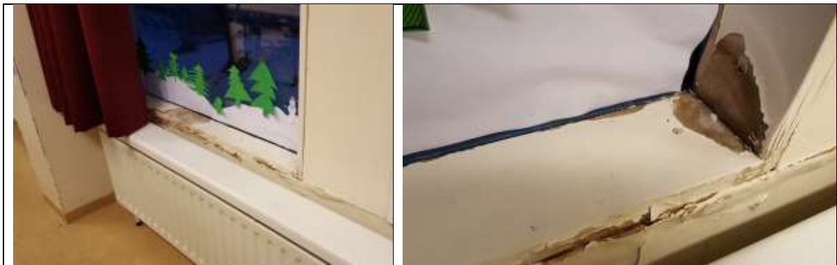
Mynd. Mála og lagfæra þarf víða innandyra bæði veggi og glugga
