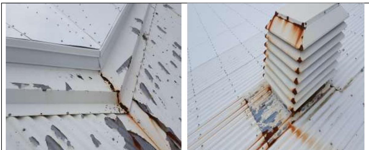
Mynd. Þakjárn þarf að endurmála/skipta út og skipta út barðaventlum, öllum loftristum og flasningum og festingum að hluta.
