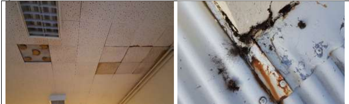
Mynd. Í A álmu þarf að skipta út loftaplötum vegna leka sem skilaði sér inn við inngang.
