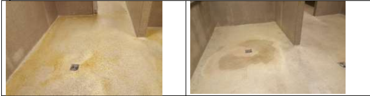
Mynd. Í búningsklefa stúlkna er epoxy gólf orðið illa farið. Í búningsklefa stráka er lakkið orðið ónýtt á nokkrum stöðum.
