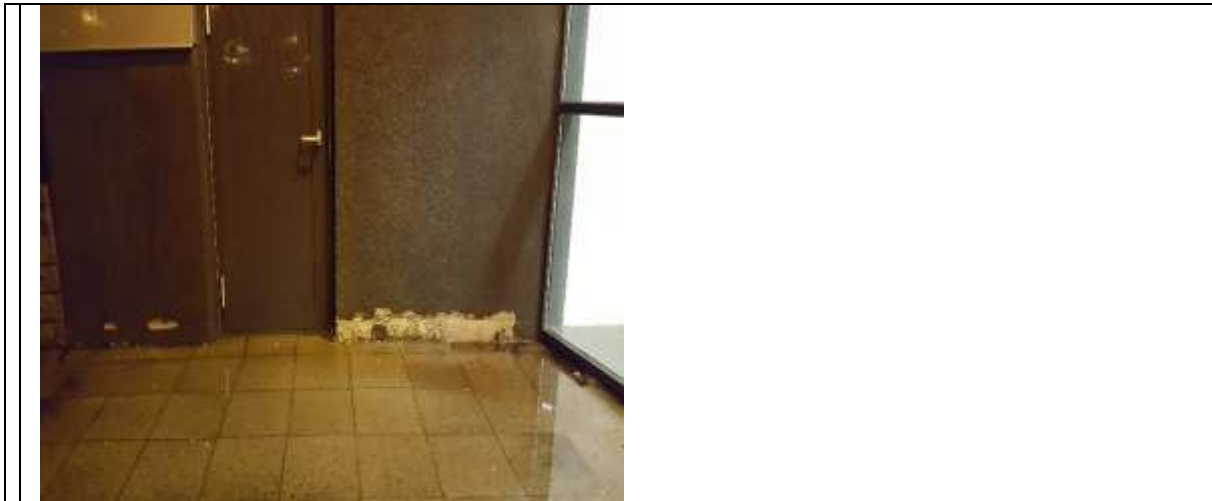
Mynd. Múrklæðning er hrunin af veggjum að hluta.
