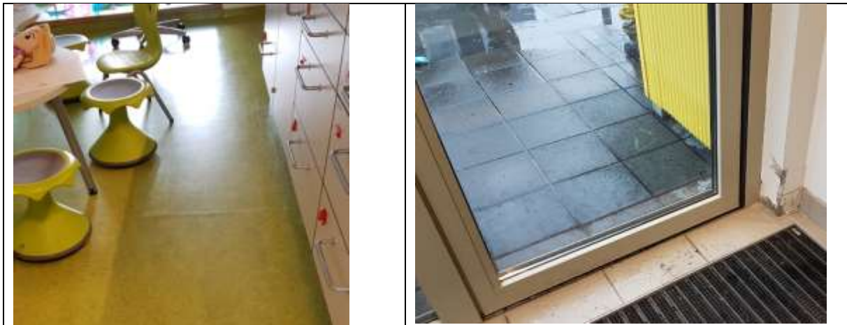
Mynd. Dúkur byrjaður að bóligna upp og flísar að losna. Laga leka við útihurðar.
