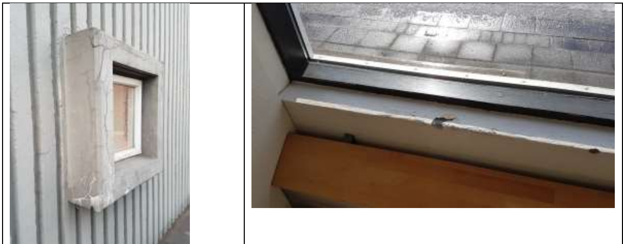
Mynd. Löngu kominn tími á sprunguviðgerðir og málun á húsi. Spasla og mála innandyra.
