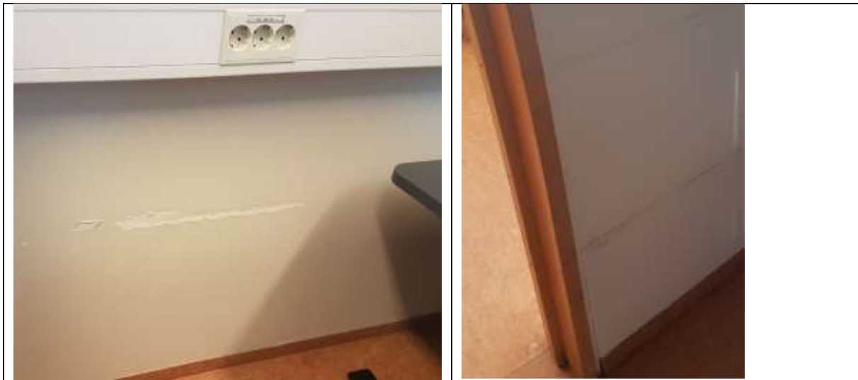
Mynd. Víða kominn tími á málun innandyr. Setja dúk á hluta veggja í gangi.
