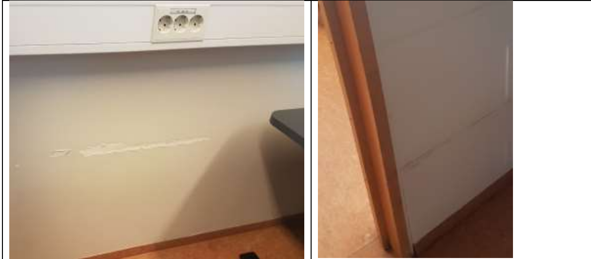
Mynd. Víða kominn tími á málun innandyrna. Setja dúk á hluta veggja í gangi.
