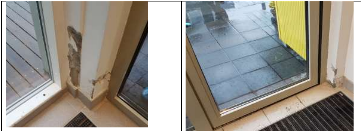
Mynd. Laga leka við glugga. Laga leka við útihurðar.
