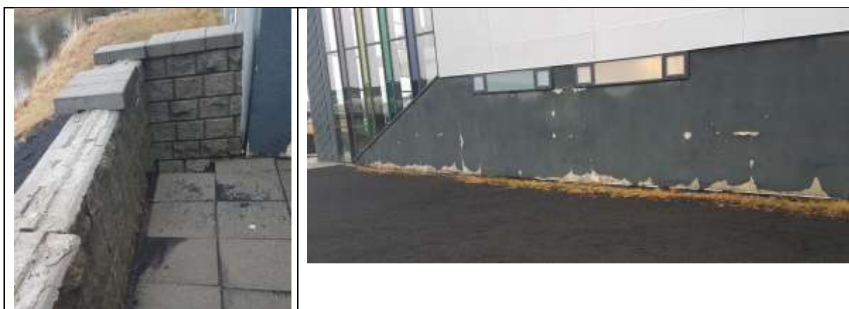
Mynd. Múrhleðsla við inngang er brotinn og er að falla á hliðina. Múrklæðning er illa farin á veggjum utanhúss.
