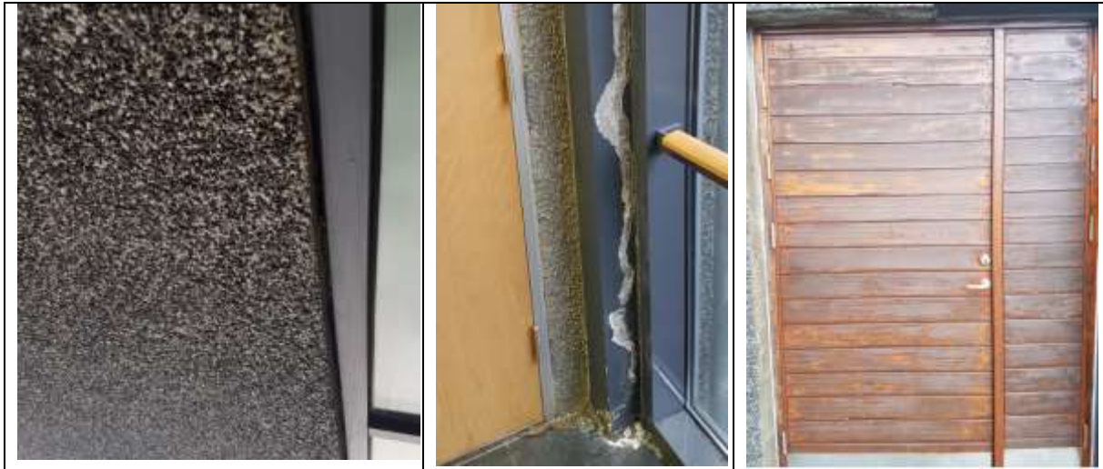
Mynd. Laga þarf rakavandamál þar sem lekur inn á nokkrum stöðum. Hurð orðin léleg á útigeymslu
