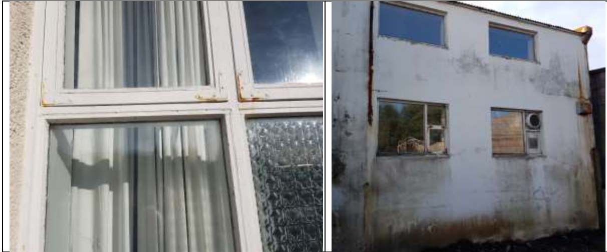
Mynd. Rið er í járni og skrúfum í gluggum Menntasetursins. Endurnýja þarf rennur á Smíðastofu, laga sprunguviðgerðir og mála eða klæða húsið
