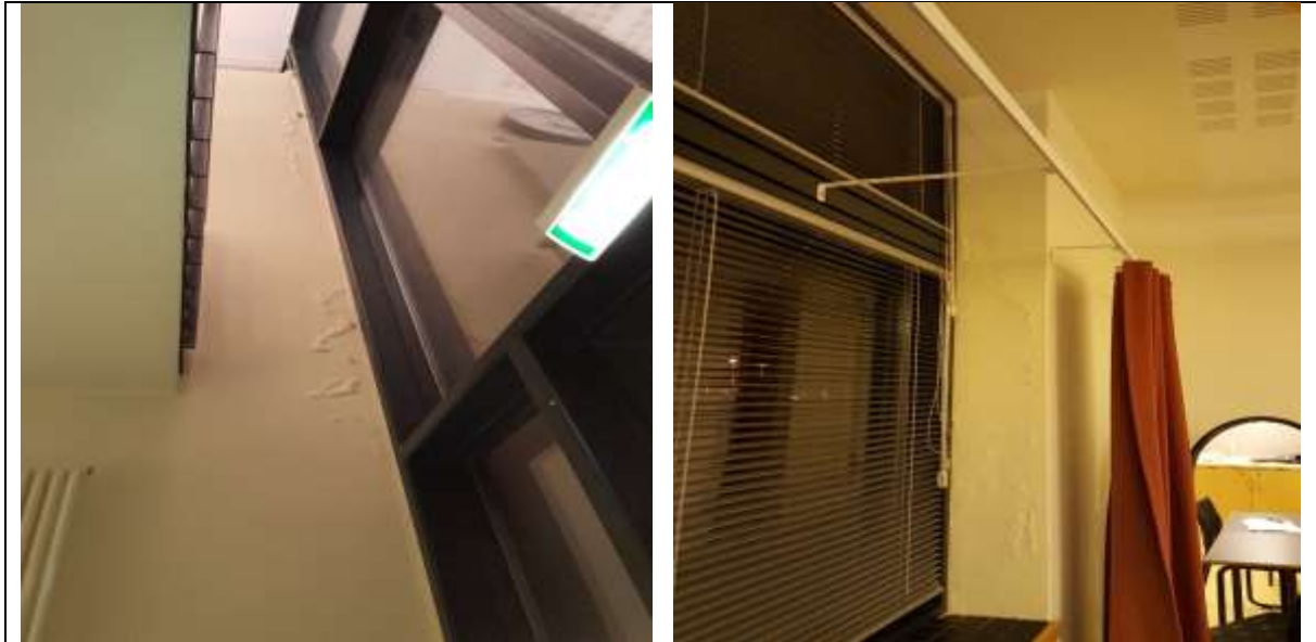
Mynd. Rakaskemmdir má sjá víðsvegar um bygginguna.
