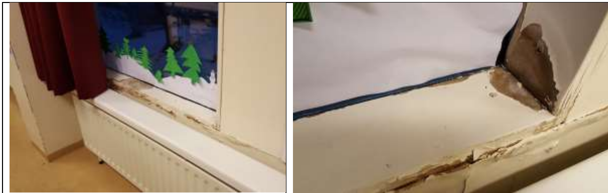
Mynd. Skipta þarf út timbri í gluggum sem er bólgið vegna gamalla leka. Á mörgum stöðum þarf að mála glugga innandyra.
