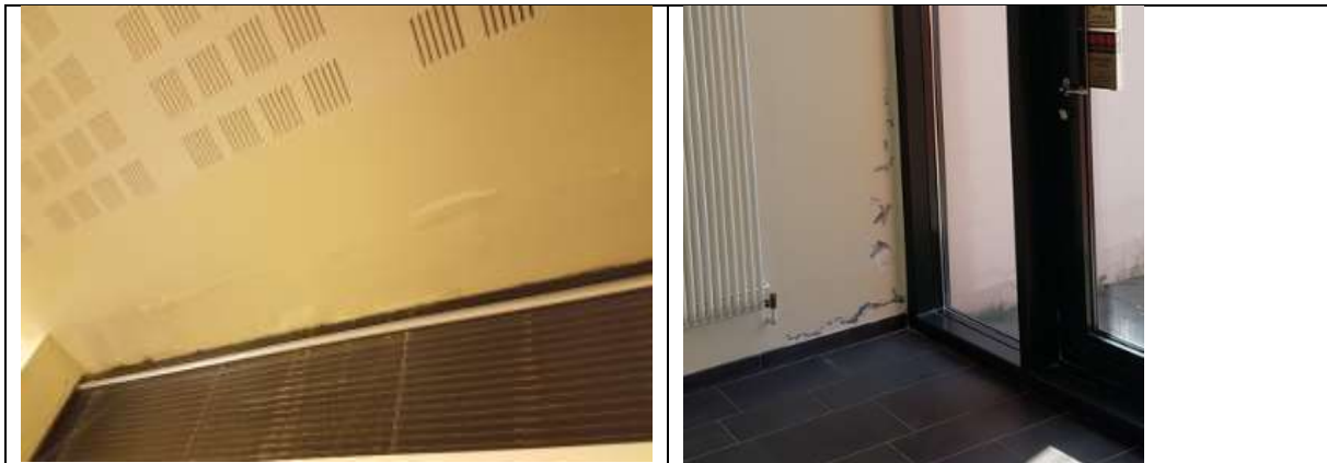
Mynd. Rakaskemmdir má sjá víðsvegar um bygginguna.
