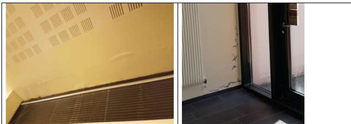
Mynd. Rakaskemmdir má sjá víðsvegar um bygginguna.
