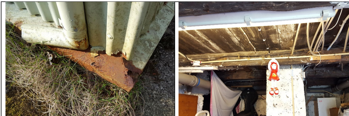
Mynd. Botnstykki orðið fúð og klæðning farin að ryðga. Í kjallara er rakavandamál og ummerki sýnileg á timburborðum og burðarbitum.
