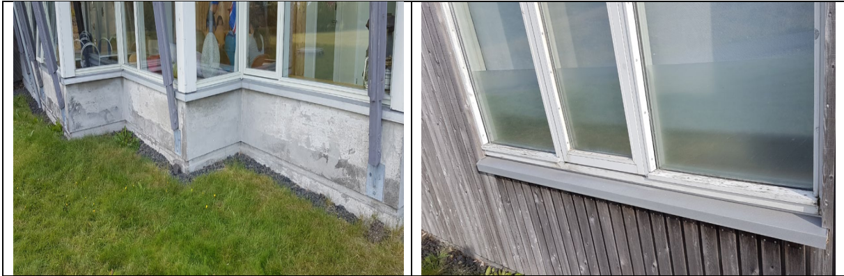
Myndir. Þarf að lagfæra veggklæðningu. Endurmála þarf glugga utanhúss.
