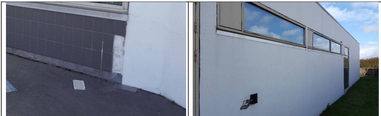
Mynd. Þarf að lagfæra veggflísar utanhúss. Lagfæra þarf sprungur í steyptum veggjum og aðrar múrskemmdir.
