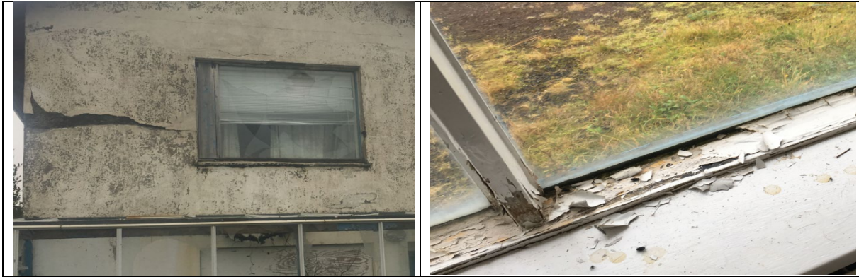
Myndir. Þarf að fara í sprunguviðgerðir og endurmálun utanhúss. Endurnýja þarf alla glugga hússins.
