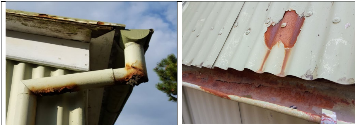
Mynd. Endurmála þarf þakjárn, jafnvel endurnýja og skipta um þakkant.
