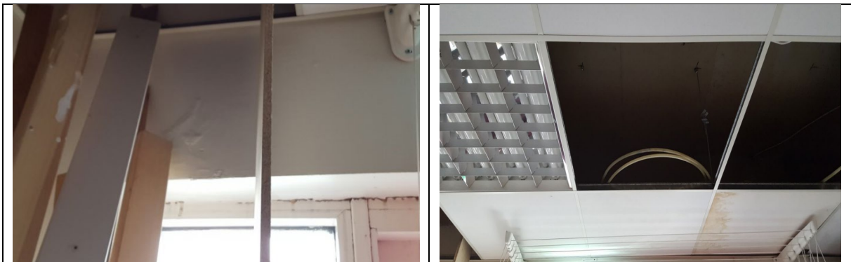
Mynd. Í þvottahúsi eru leka og rakavandamál, ummerki bólgin málning. Gera þarf endurbætur innanhúss þegar búið er að koma í veg fyrir leka og raka.
