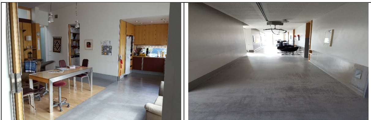
Mynd. Parket þarf að endurlakka og bóna gólfduka. Endurmála þarf vegg, glugga og hurðarkarma.
