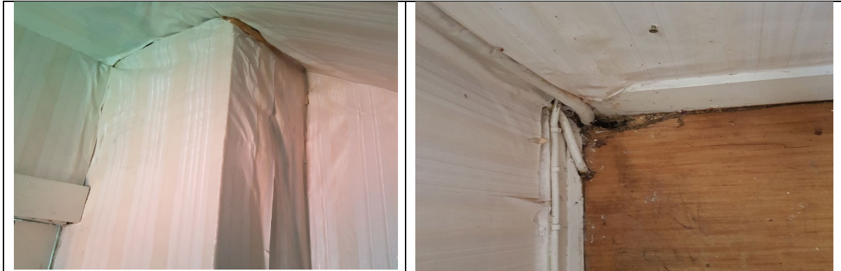
Mynd. Endurnýja þarf veggklæðningu vegna leka. Endurnýja þarf gólfefni.
