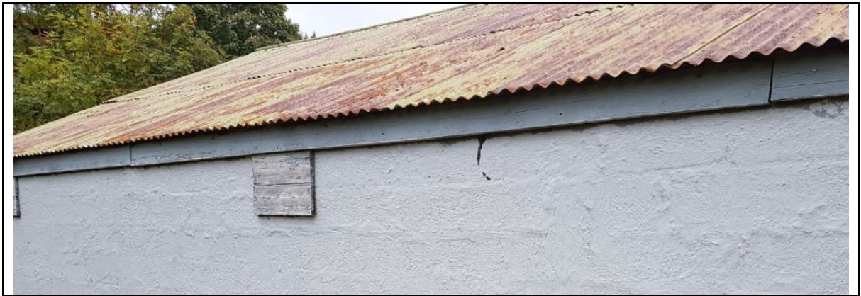
Myndir. Endurnýja þarf þakjárn, rennur og niðurföll.
