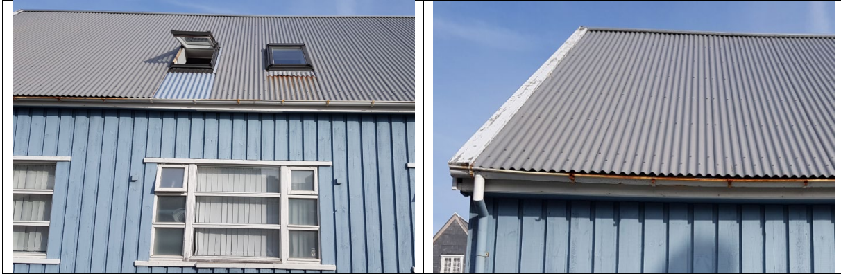
Myndir. Endurmála þarf þakjárn og lagfæra rennur.
