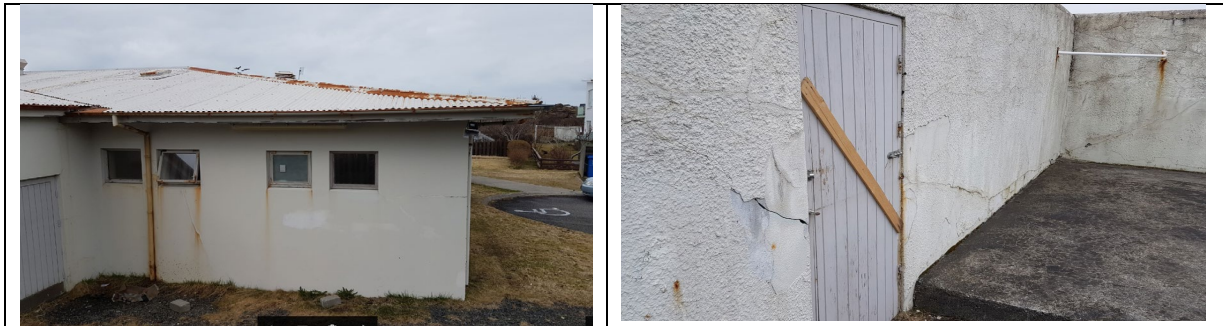
Mynd. Fara þarf í múr- og sprunguviðgerðir á húsinu og skjólveggjum. Endurmála þarf steypa fleti.
