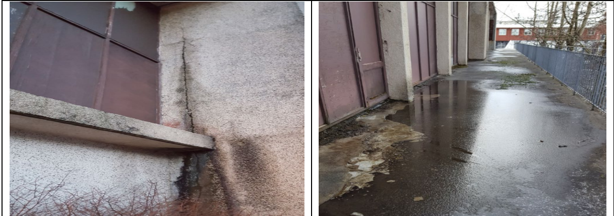
Mynd. Endurnýja þarf klæðningu á íþróttahúsi og fara í sprunguviðgerðir. Endurnýja þarf svalagólf.
