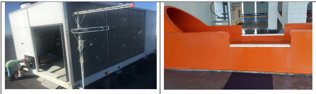
Mynd. Kæliraftur á þaki ónýtur. Rennibraut byrjuð að springa við útgang, þarfnast lagfæringar og aukna styrkingu.
