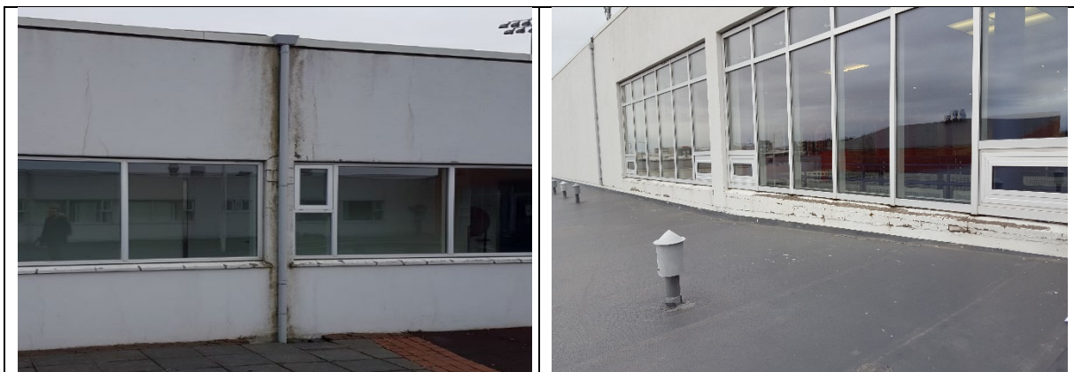
Mynd. Fara þarf í múr- og sprunguviðgerðir og laga niðurföll.
