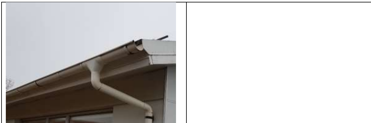
Mynd. Rennur þarf að yfirfara og laga á nokkrum stöðum
