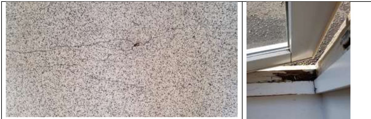
Mynd. Laga þarf sprungur í gólfefni. Laga fúa í hurðum sem vísa út í garð.
