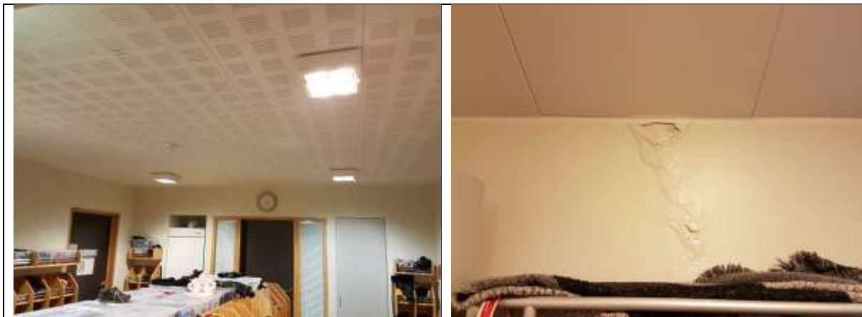
Mynd. Laga loftræstingu endurnýja ljósbúnað. Mála þarf víða vegg í húsinu.
