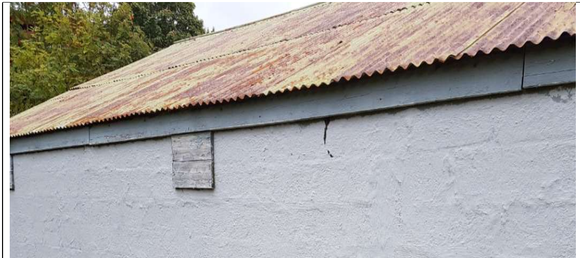
Myndir. Endurnýja þarf þakjárn, rennur og niðurföll.
