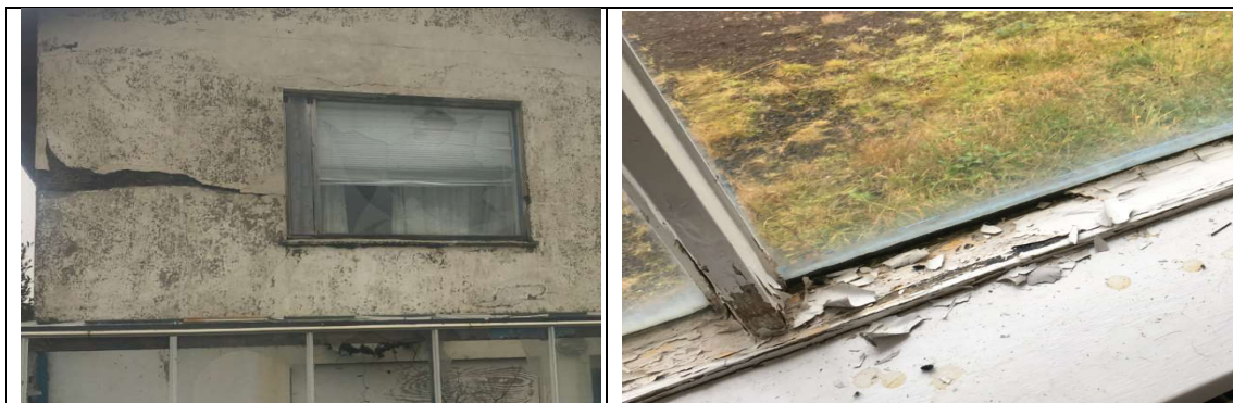
Myndir. Þarf að fara í sprunguviðgerðir og endurmálun utanhúss. Endurnýja þarf alla glugga hússins.
