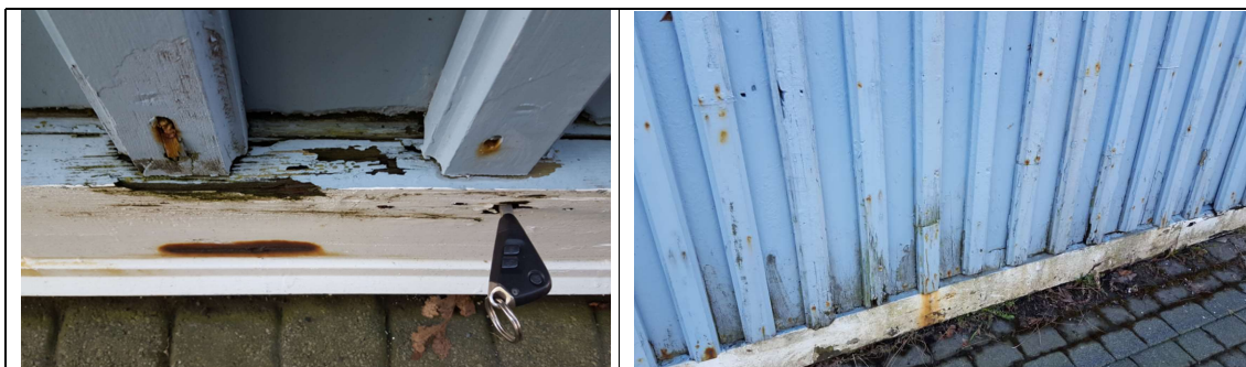
Myndir. Í veggklæðningu og botnstykki er kominn töluverður fúi, búið er að endurnýja að hluta.
