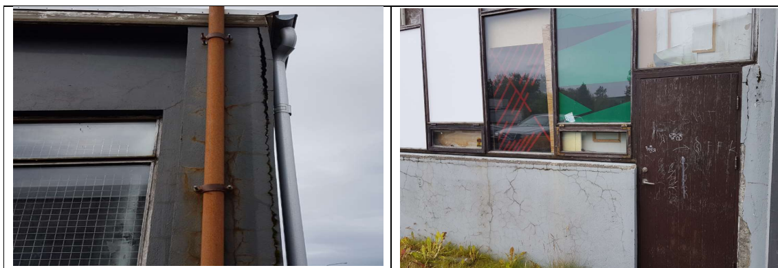
Mynd. Endurnýja þarf múrklæðningu að hluta og fara í sprunguviðgerðir.
