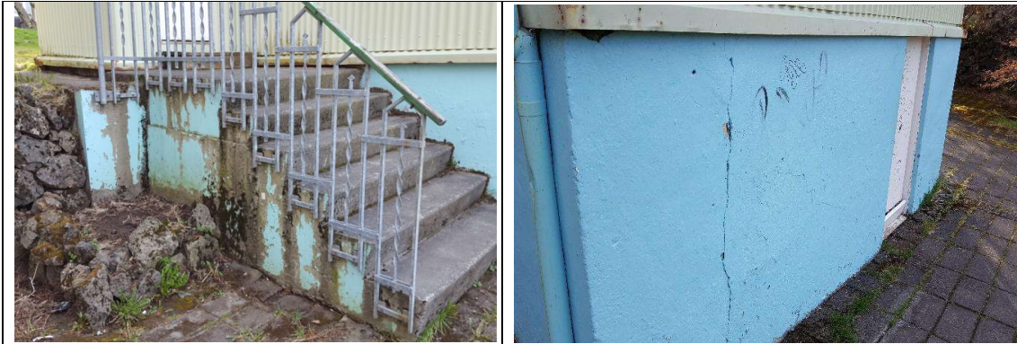
Mynd. Gera þarf við steypuskemmdir.
