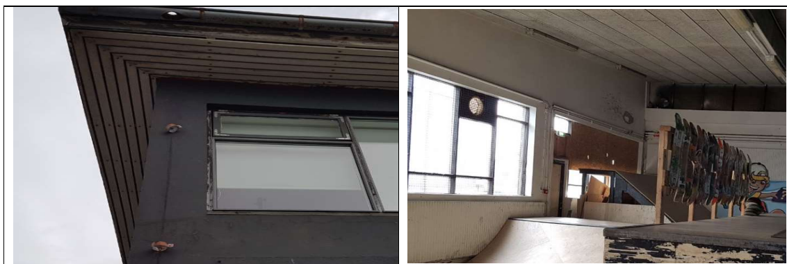
Mynd. Endurnýja þarf tréverk að hluta. Endurnýja þarf rennur og niðurföll. Endurmála þarf veggi og lakka gólf innanhúss.
