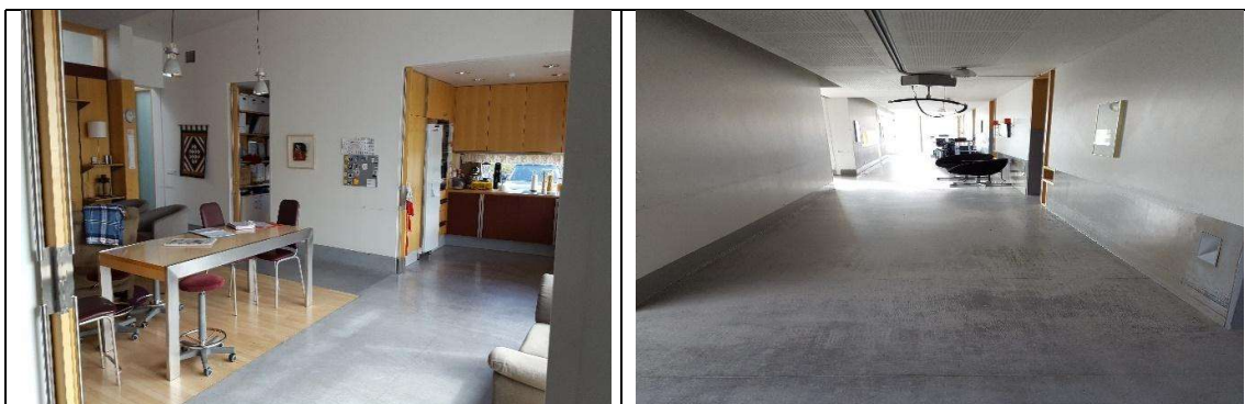
Mynd. Parket þarf að endurlakka og bóna gólfduka. Endurmála þarf veggi, glugga og hurðarkarma.
