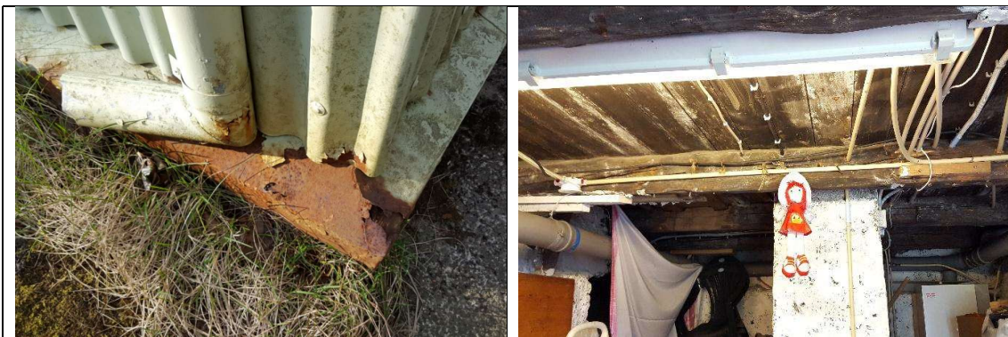
Mynd. Botnstykki orðið fúíð og klæðning farin að ryðga. Í kjallara er rakavandamál og ummerki sýnileg á timburborðum og burðarbitum.
