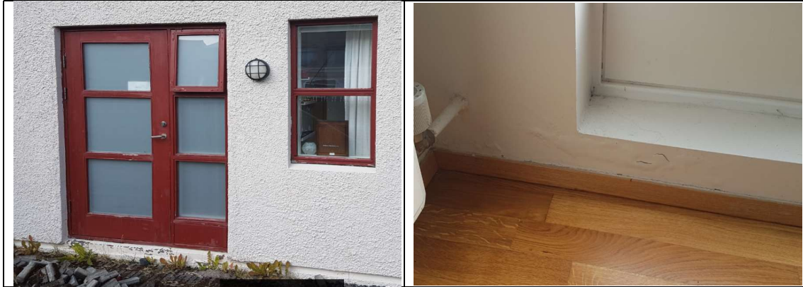
Mynd. Koma þarf í veg fyrir leka með hurð og lagfæra rakaskemmdir innanhúss.
