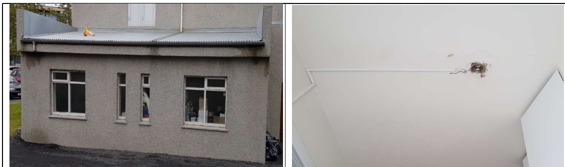
Myndir. Laga þarf leka á þaki á tveimur stöðum.
