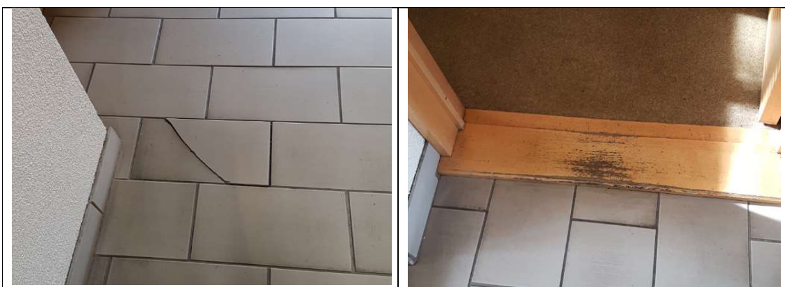
Myndir. Endurnýja þarf gólfflísar að hluta. Þarf að þússa og lakka þröskulda.
