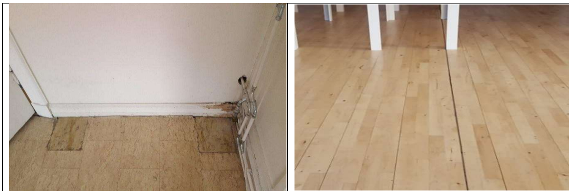
Mynd. Á 2. hæð er þörf á að endurnýja gólfefni. Parket á sýningarsal þarfnast viðgerðar.
