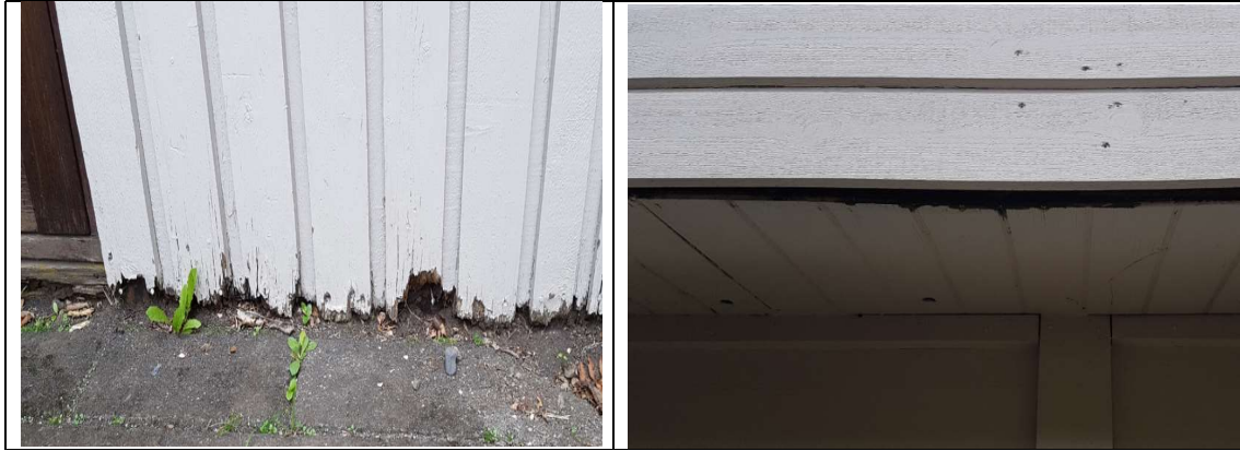
Mynd. Endurnýja þarf veggklæðningu og þakkað að hluta vegna fúa.
