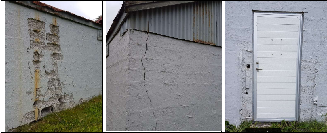
Myndir. Holsteinar eru illa farnir og nauðsynlegt að fara í sprunguviðgerðir á húsinu.
