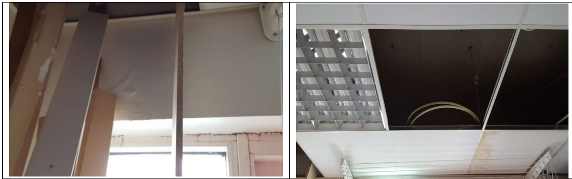
Mynd. Í þvottahúsi eru leka og rakavandamál, ummerki bólgin málning. Gera þarf endurbætur innanhúss þegar búið er að koma í veg fyrir leka og raka.
