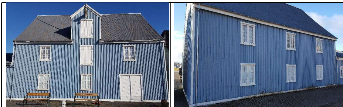
Myndir. Þakjárn er farið að ryðga, búið að skipta um.
