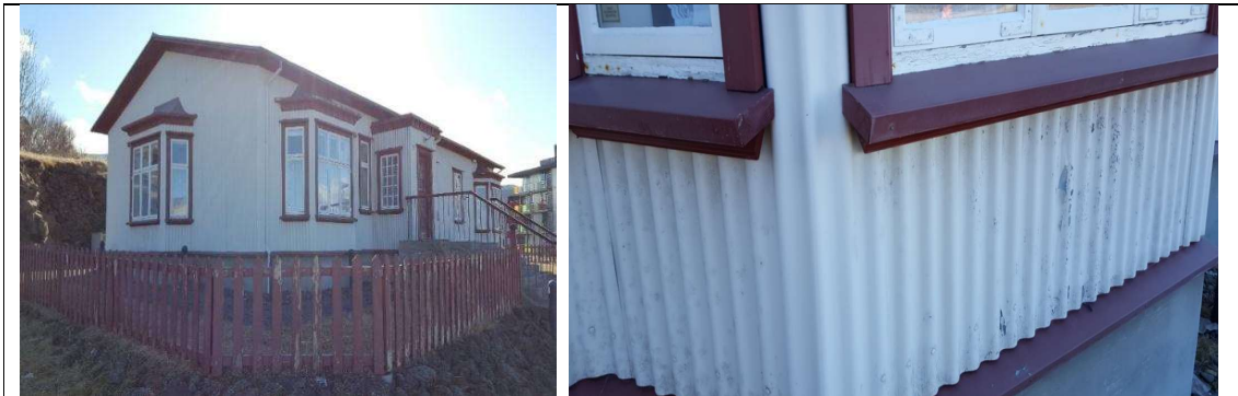
Mynd. Endurmála þarf bárujárnsklæðningu.
