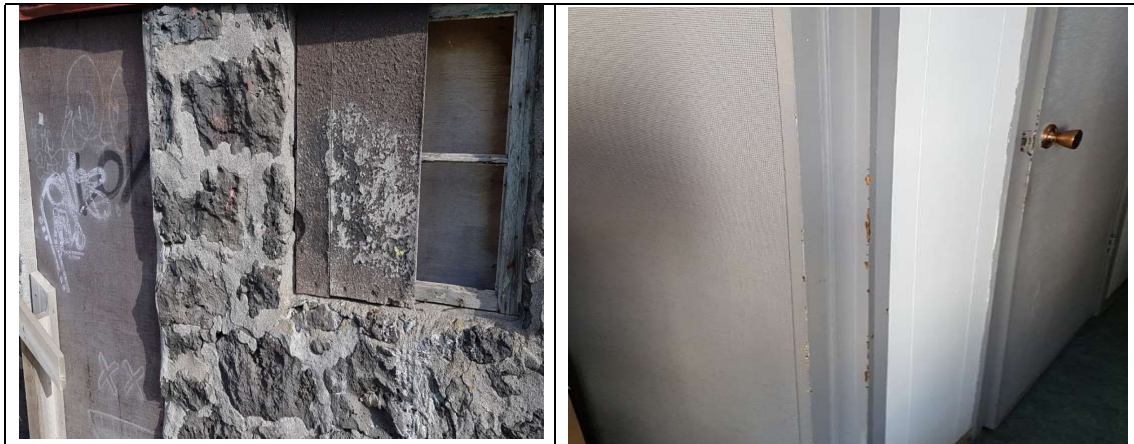
Myndir. Endurnýja þarf glugga og hurð í kjallara. Endurmála þarf vegg og annað tréverk innanhúss.
