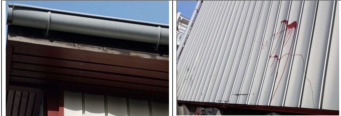
Myndir. Endurmála þarf tréverk utanhúss, yfirfara rennur og niðurföll og þrifa klæðningu.
