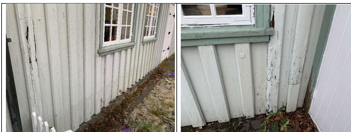
Myndir. Endurnýja þarf veggklæðningu og glugga vegna fúa.
