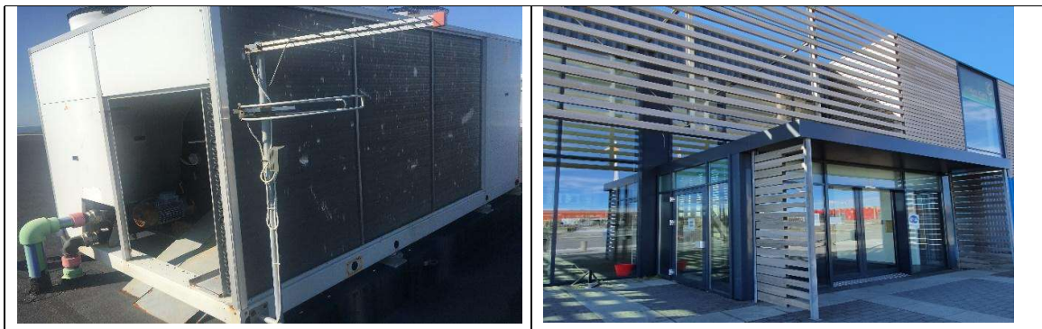
Mynd. Kæliraftur á þaki ónýtur. Vindbrjót vantar við inngang og breyta klifurgrindum.
