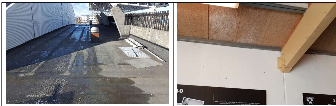
Mynd. Endurnýja þarf þak á tengibyggingu í A álmu vegna leka. Innanhúss þarf að laga eftir lekann.
