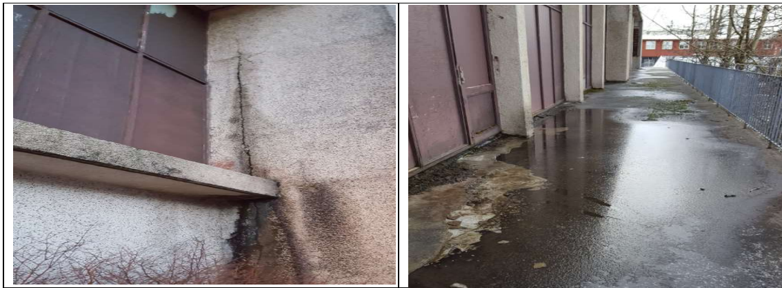
Mynd. Endurnýja þarf klæðningu á íþróttahúsi og fara í sprunguviðgerðir. Endurnýja þarf svalagólf.
