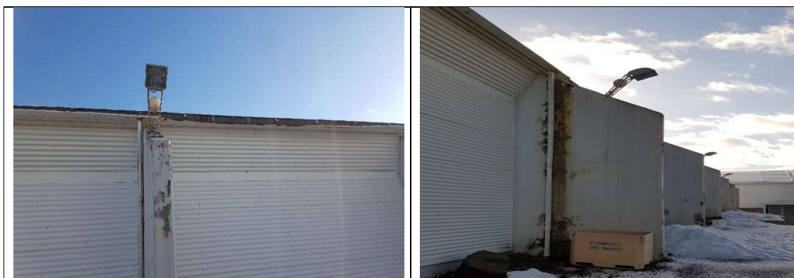
Mynd. Í B álmu þarf að endurnýja rennur og niðurföll, gera við steypa fleti og endurmála.
