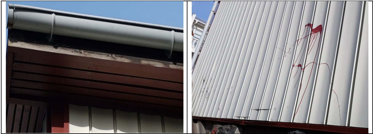
Myndir. Endurmála þarf útveggjaklæðningu og þakkant.
