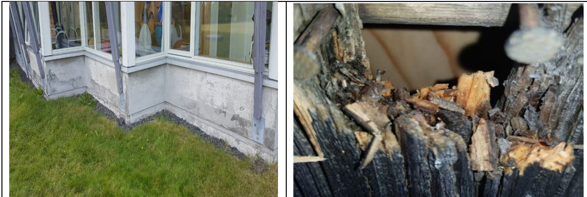
Myndir. Þarf að endurnýja útveggjaglæðningu.
