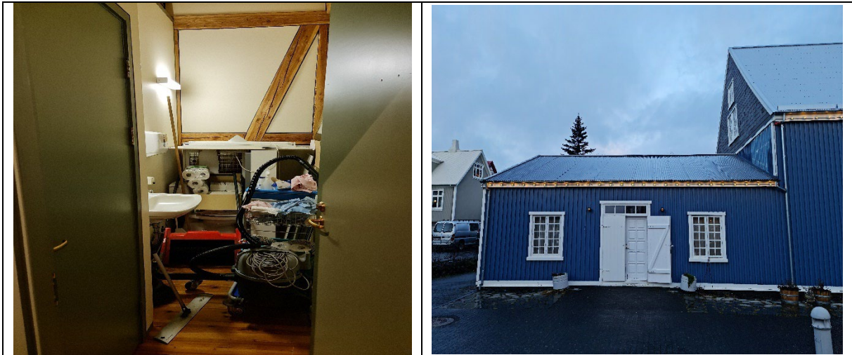
Myndir. Útbúa þarf rými fyrir ræstingu. Endurnýja þarf þakklæðningu á lægri byggingu.
