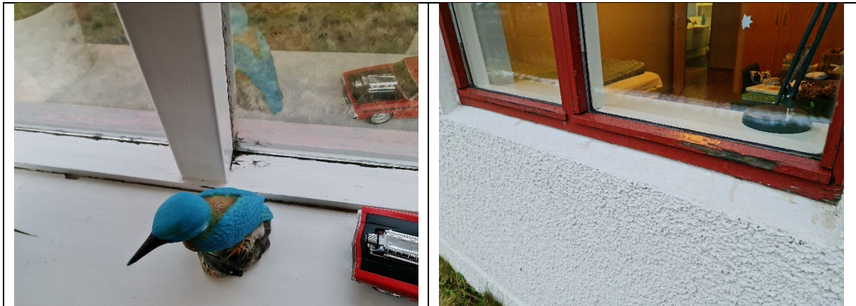
Myndir. Yfirfara þarf glugga á austur- og suðurhlið m.t.t. fúa og endurmála úti og inni.
