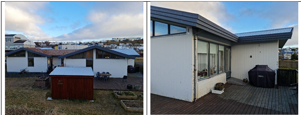
Myndir. Endurnýja þarf þakjárn að hluta. Bera á timburpall og skjólveggi.
