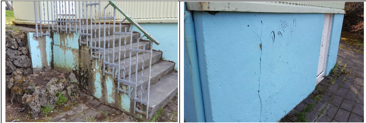
Myndir. Gera þarf við steypuskemmdir.
