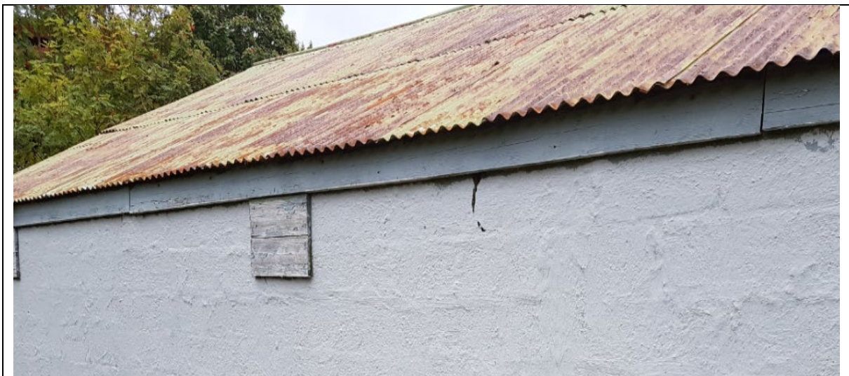
Myndir. Endurnýja þarf þakjárn, rennur og niðurföll.
