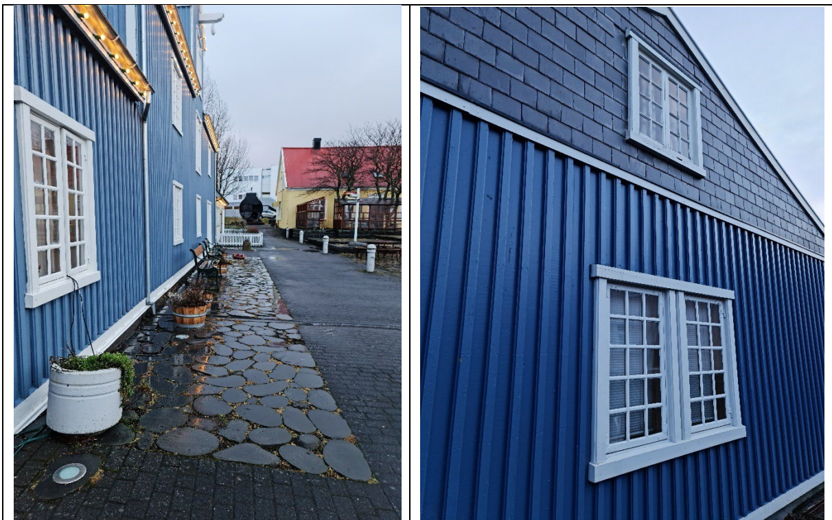
Myndir. Yfirfara þarf lýsingu á lóðinni, virkar ekki sem skyldi. Endurnýja þarf veggklæðningu á vesturhlið vegna fúa.
