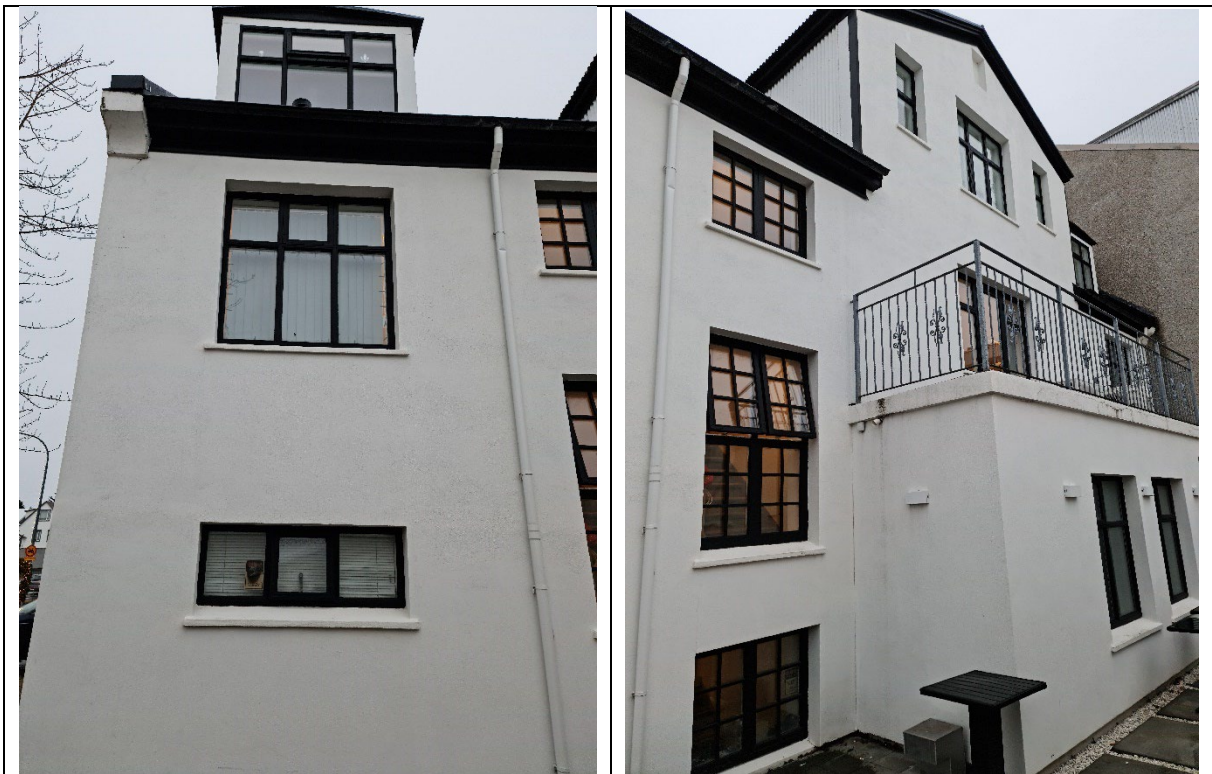
Myndir. Yfirfara þarf þéttingar með gluggum. Lagfæra þarf steypa kanta á svölum.
