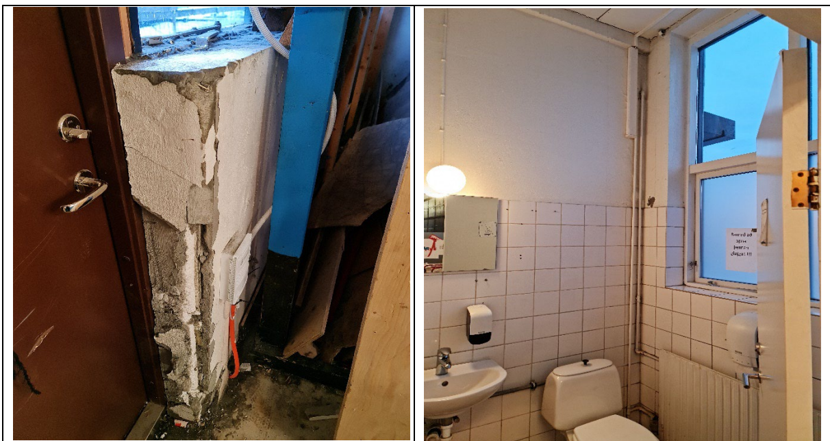
Mynd. Fara þarf í múrviðgerðir innanhúss. Koma þarf í veg fyrir leka frá þaki inn á salerni.
