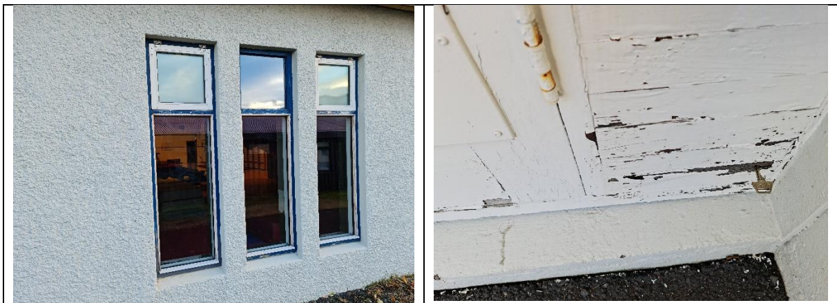
Myndir. Endurmála þarf glugga og hurðir á suður- og austurhlið. Endurnýja þarf timburverkað hluta vegna fúa.
