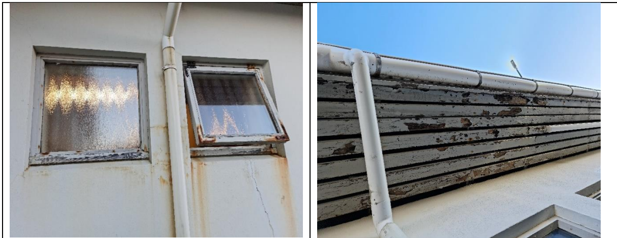
Myndir. Endurmála þarf alla glugga á vestur- og norðurhlið sem og þakkant, skipta þarf út ryðguðum festingum.
