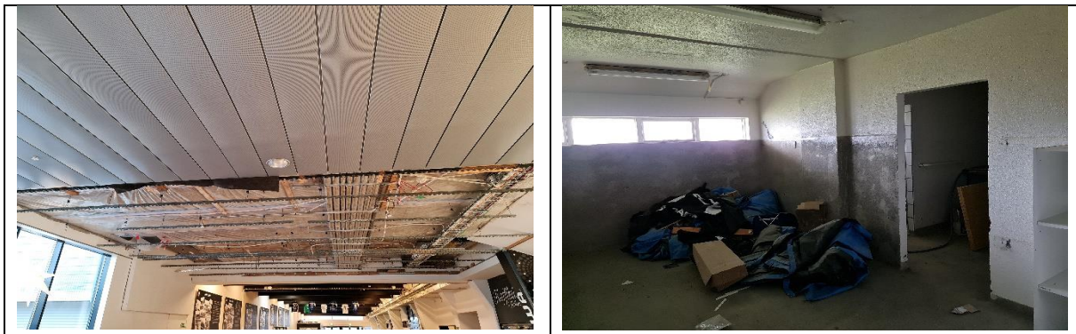
Myndir. Setja þarf upp nýja loftaklæðningu vegna viðgerða á þaki tengibyggingar. Endurnýja þarf búningsklefa og geymslur á 1. hæð frá grunni.
