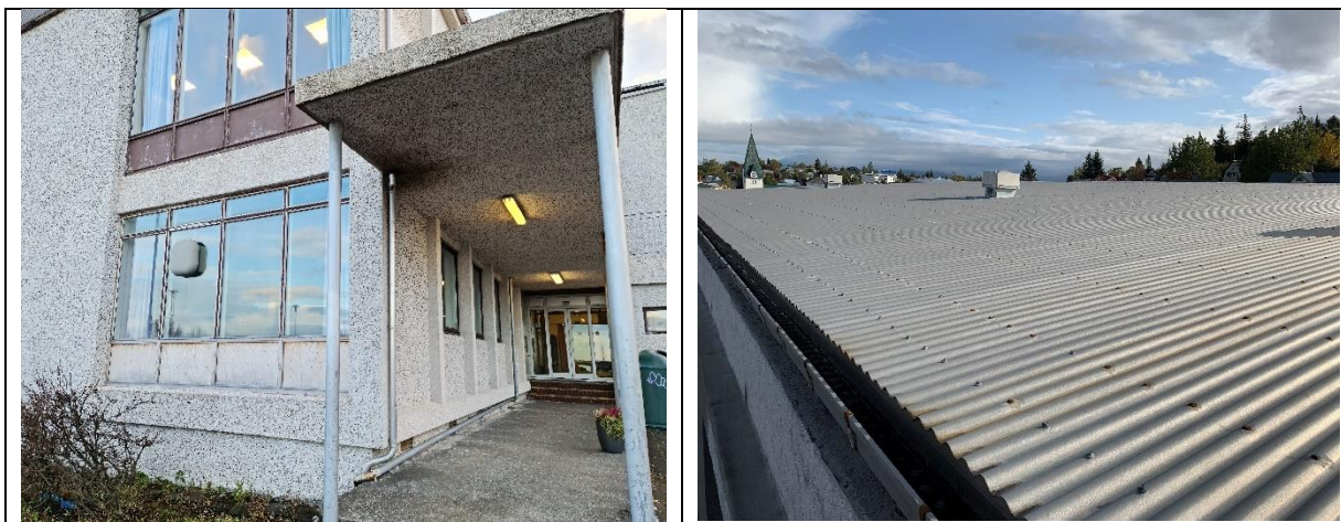
Myndir. Halda þarf áfram að endurnýja glugga hússins. Mála þarf þakklæðningu og skipta út ryðguðum festingum.
