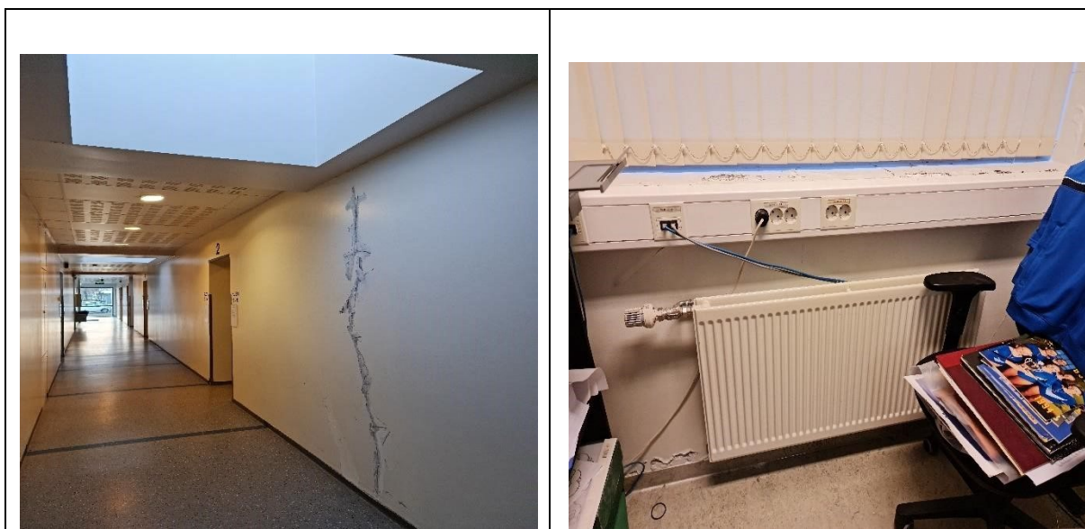
Myndir. Lekavandamál á tveimur stöðum sem þarf að koma í veg fyrir.
