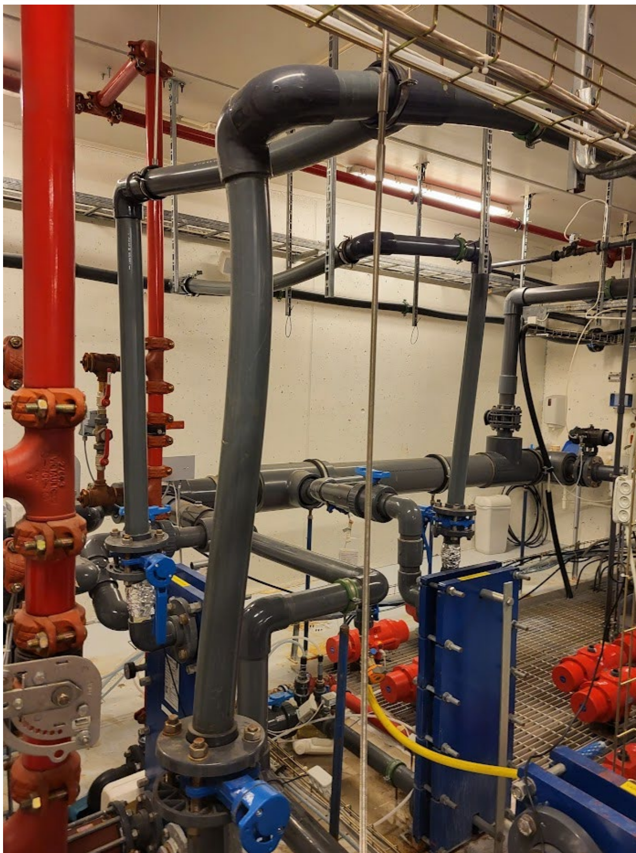
Myndir. Víða enn vandamál frá vali byggingaefna í upphafi.
