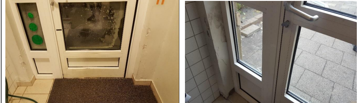
Mynd. Rakaskemmdir við útidyrhurðir.
