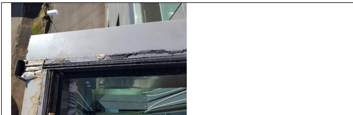
Mynd. Frágangur álkerfis við steypa vegg og glugga er ekki í lagi og og veldur lekum innandyrna
