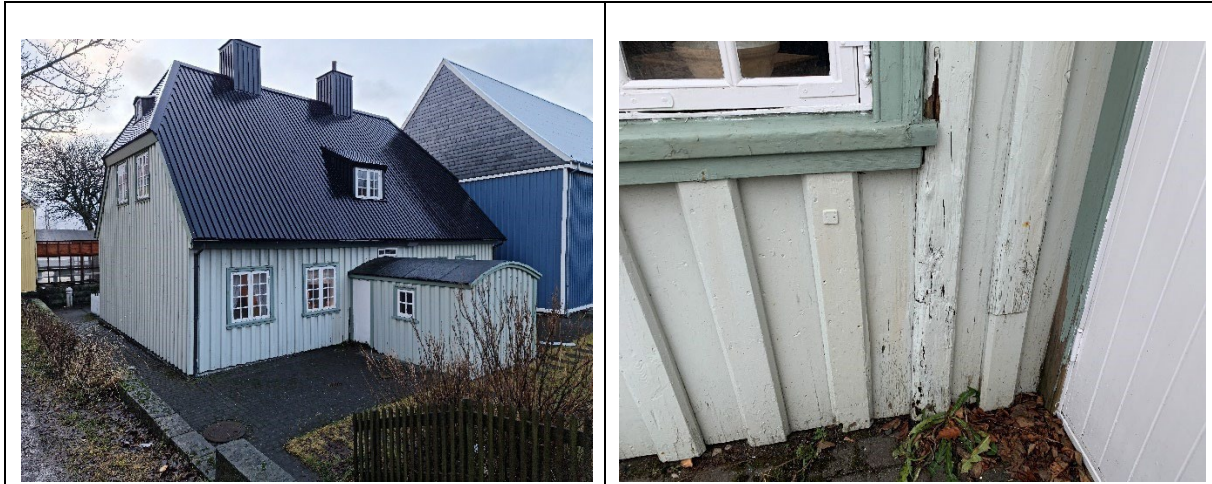
Myndir. Endurnýja þarf útveggjaglæðningu á norðurhlíð vegna fúa.
