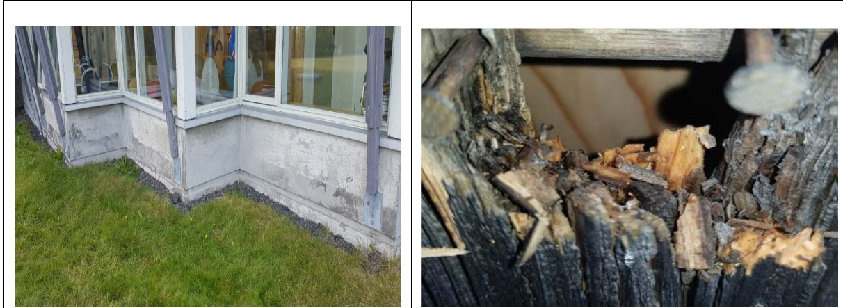
Myndir. Þarf að endurnýja útveggjaklæðningu.
