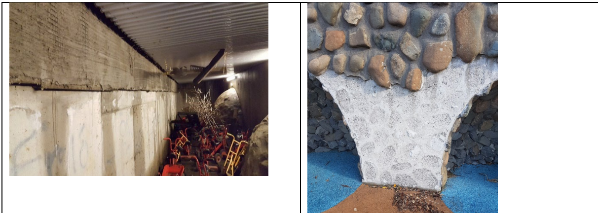
Mynd. Geymsla undir palli austanmegin er lek. Steinklæðning á geymslunni er hrunin af að hluta.
