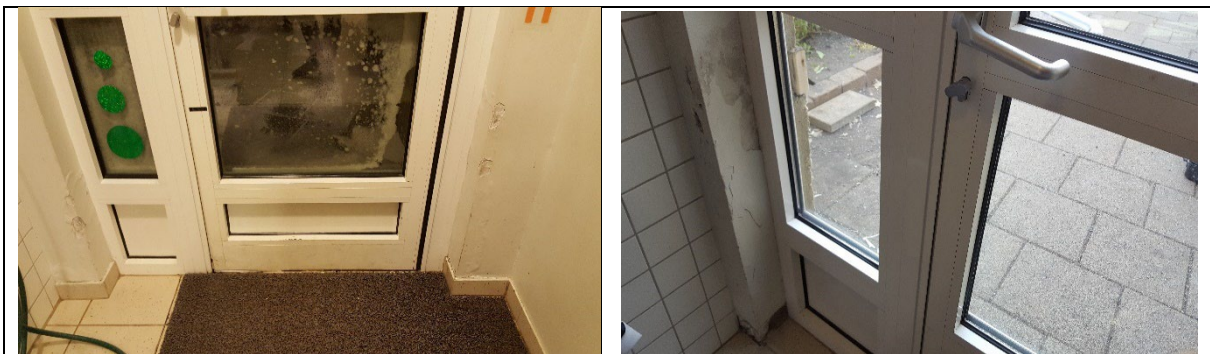
Mynd. Rakaskemmdir við útidyrhurðir.
