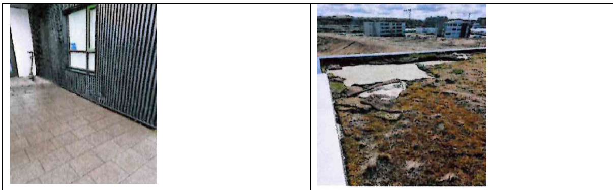
Mynd. Báruklæðning víða skemmd. Torf farið að losna af þaki A álmu.
