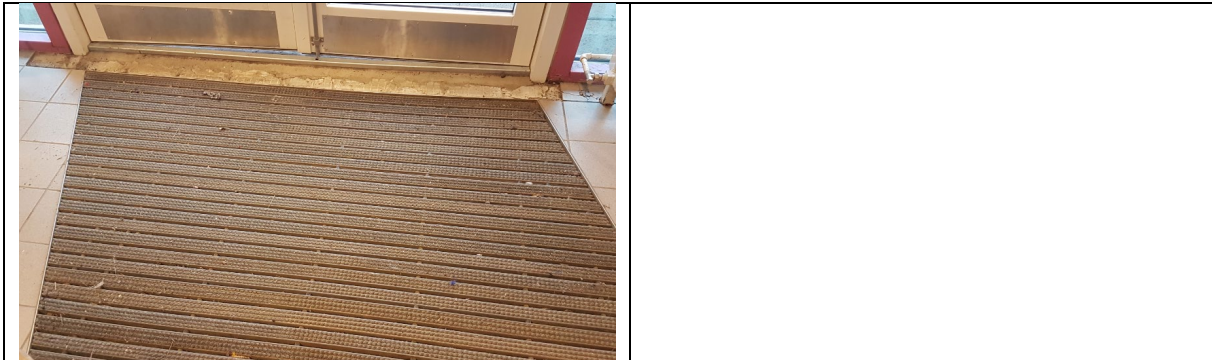
Mynd. Laga þarf gólfefni víða við innganga.
