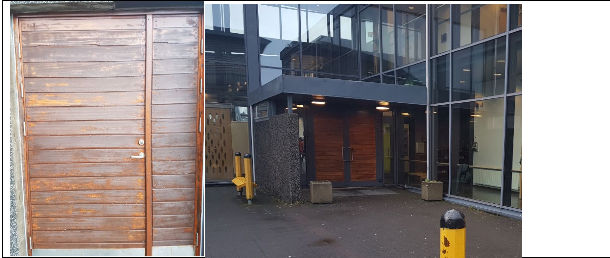
Mynd. Hurð orðin léleg á útigeymslu Bæta þarf aðgengi fatlaðra og setja rafmagnsopnanir á útihurðar.
