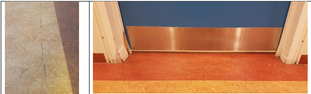
Mynd. Laga þarf gólfefni s.s. yfirfara suður og laga sprungur í dúkum. Hurðakarmar víða orðnir uppblógnir vegna raka frá ræstingu.
