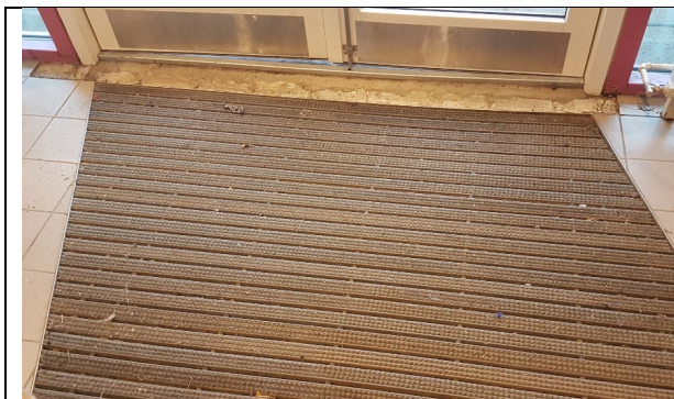
Mynd. Laga þarf gólfefni víða við innganga.
